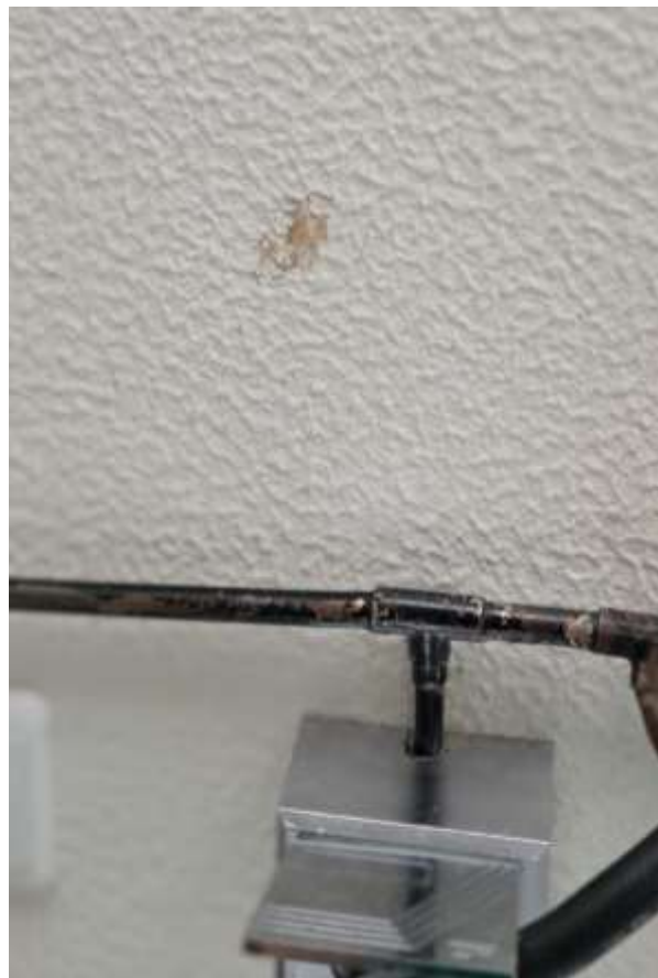
Restos de adesivo na parede
