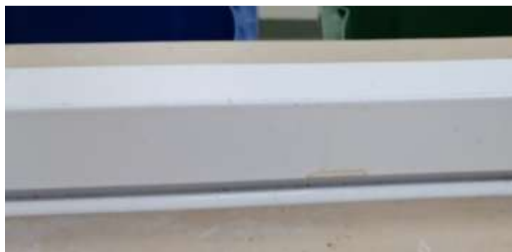
Fig.4 – Janela do armazém de limpos visivelmente suja
