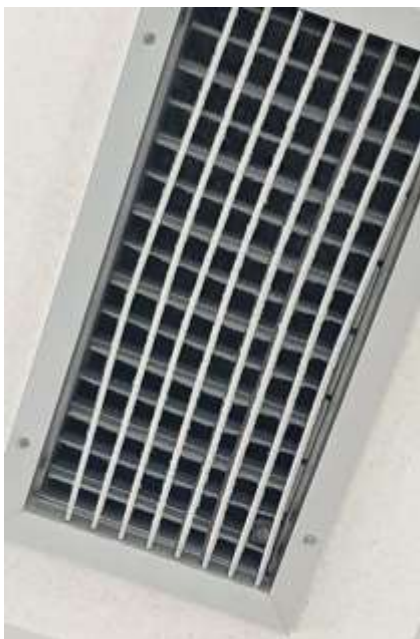
Grelha cheia de algodão por cima das Máquinas – Zona de Limpos
