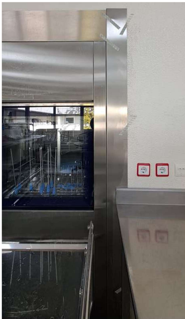
Parede e Maquina de Lavar com Adesivos – Zona de Limpos
