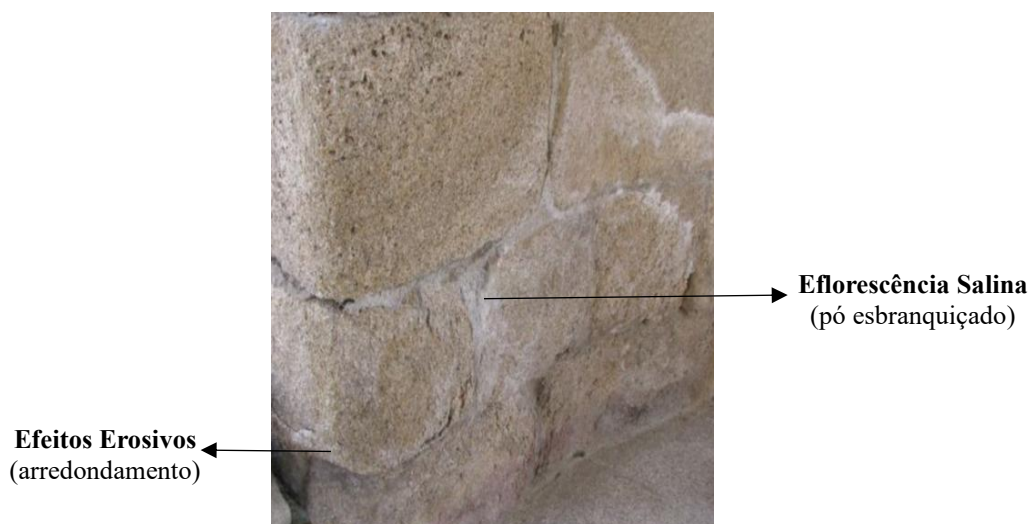
Figura 15: Eflorescências salinas e efeitos erosivos em pedras graníticas numa estrutura histórica na cidade de Chaves, Portugal (adaptado de Alves et al. , 2021)
