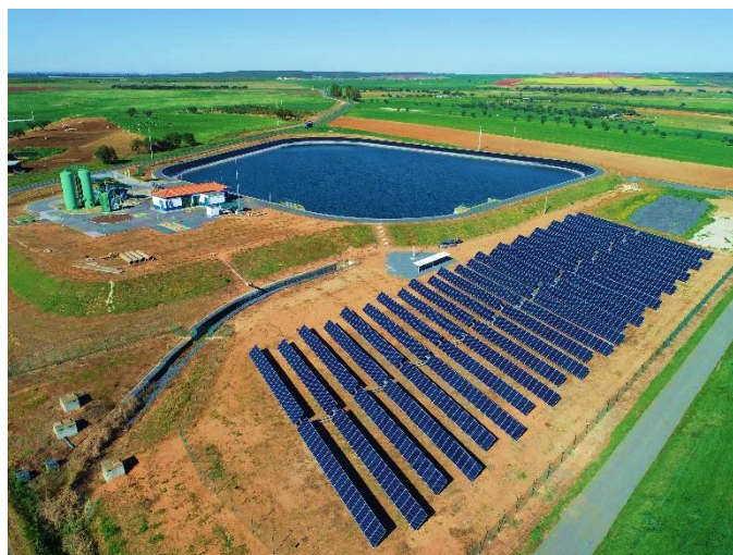
Figura 9 – Sistema de Bombagem Fotovoltaica da Associação de Beneficiários do Roxo ( O Instalador, 2020 )
