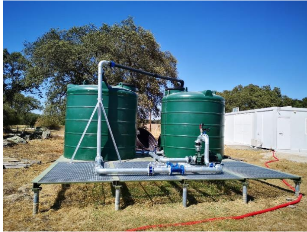
Figura 21 - Circuito de Bombagem real construído na CERUÉ
