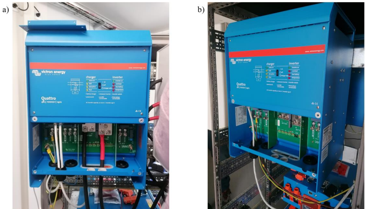
Figura 28 - a) Vista Frontal de um dos inversores; b) Vista Lateral de um dos inversores utilizados na instalação
