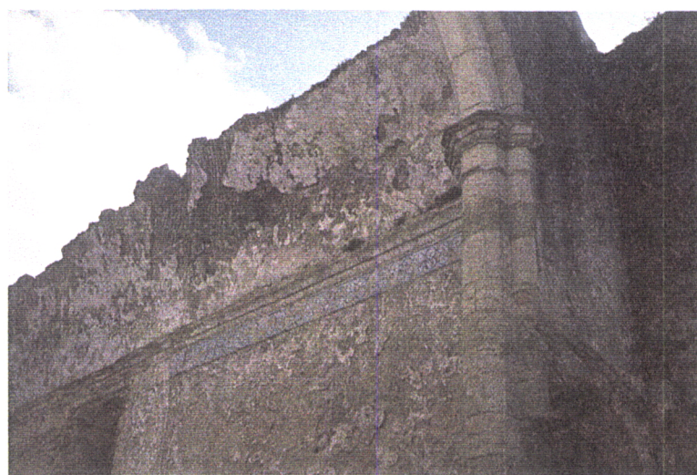
Fig. 5.9 – Friso de azulejos, sob as cornijas da capela-mor. Parede interior do alçado sul. 1995.
