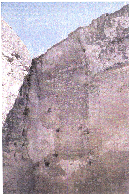
Fig. 3.14 – Interior da Igreja do Convento de N. S. das Virtudes (Azambuja, 1996. Vão entaipado na parede do alter-mor.
