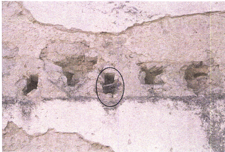
Fig. 3.22 – Exterior da Igreja do Convento de N. S. das Virtudes. Março, 1997. Pedaco de madeira dentro de um orifício, na parede do alçado norte da nave.
