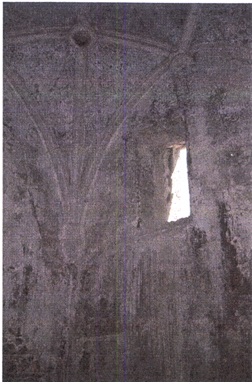
Fig. 3.49 – Capela anexa à Igreja. 1996. Fresta no alçado sul.
