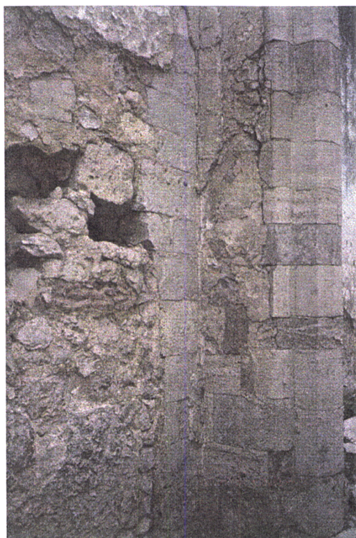
Fig. 4.15 – Interior da Igreja das Virtudes. 1995. Silhares do cunhal da capela-mor que encosta ao arco triunfal da Igreja (lado sul).
