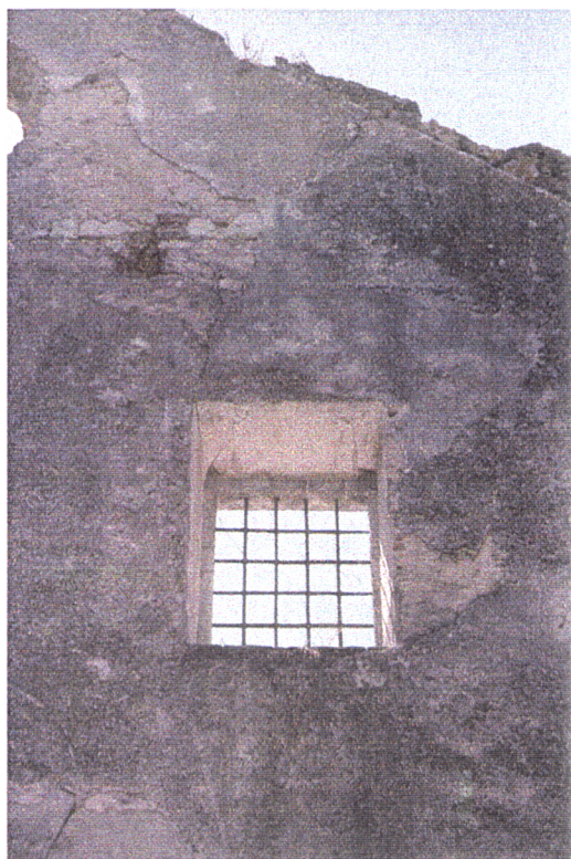
Fig. 3.32 – Interior da Igreja do Convento de N. S. das Virtudes (Azambuja). 1996. Janela situada no alçado principal.
