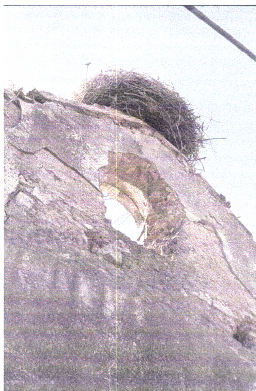
Fig. 3.33 – Nicho campaniforme, destruído, localizado no alçado principal.. 1996.
