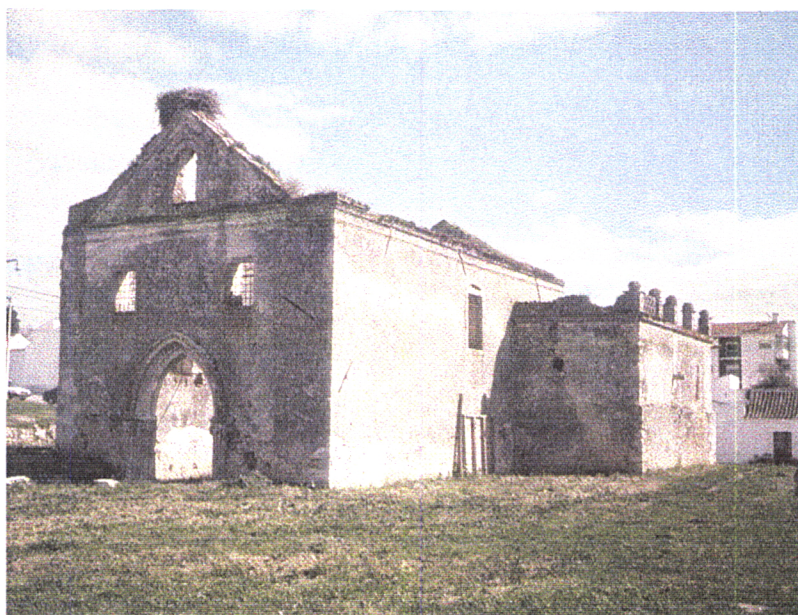
Fig. 3.42 – Igreja do Convento de N. S. das Virtudes (Azambuja). Julho, 1995. Alçados poente e sul. Observam-se as cinco pontas dos tirantes e a sobrelevação do terreno.
