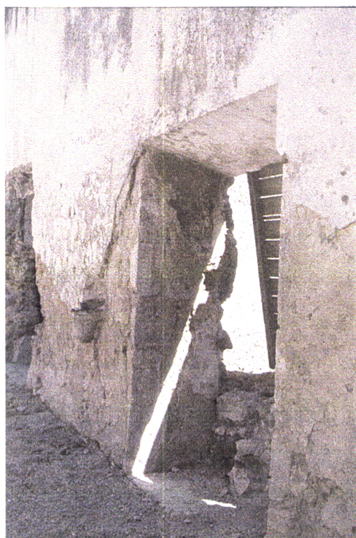
Fig. 3.25 – Interior da Igreja do Convento de N. S. das Virtudes (Azambuja). 1996. Porta de acesso ao exterior, parcialmente entaipada devido à elevação do terreno.
