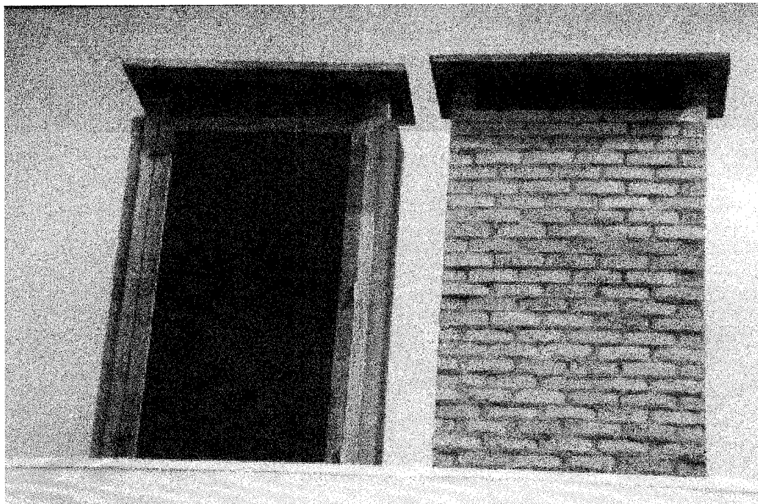
Fig. 4.11 - Vista da chaminé solar e da chaminé convencional.
