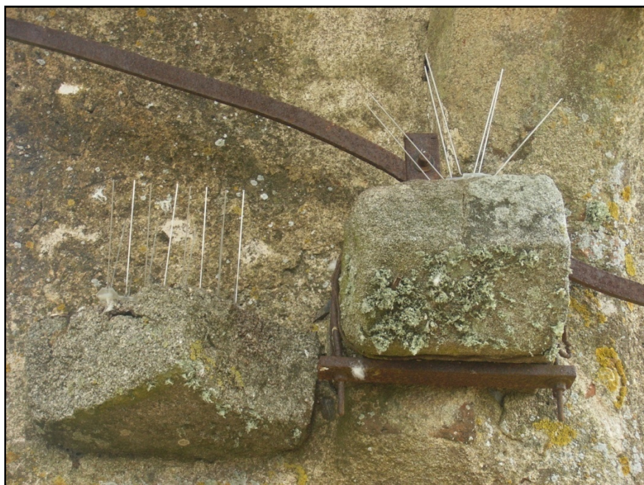
Figura 58 - Dissuasores da Torre do Relógio – Sistema Avipoint (Ana Abelha – 2011)
