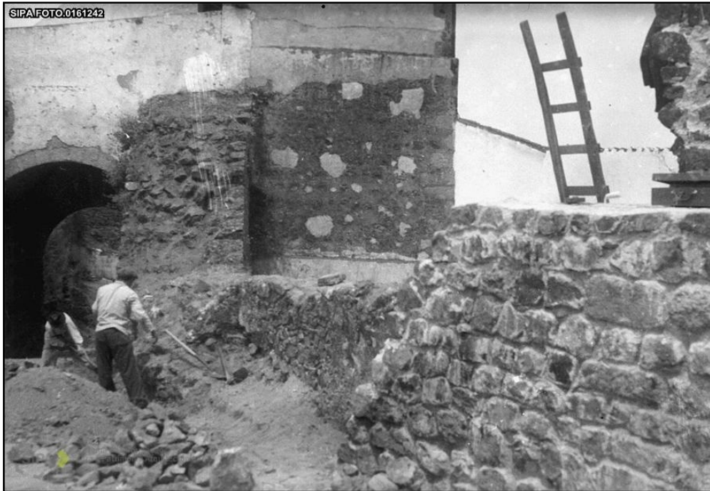
Figura 34 - Pano da muralha norte do Castelo de Montemor-o-Novo, durante a realização das obras da década de 40
