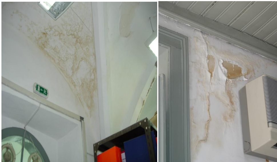
Figura 5.43 e 5.44 - Sujidade e descasque devido à infiltração de água.
