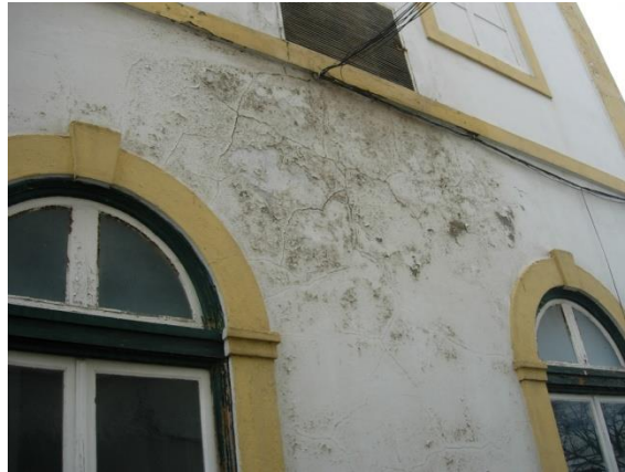
Figura 5.42 - Mancha localizada na parede exterior.
