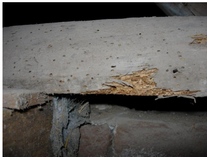
Figura 5.35 - Madeira atacada por xilófagos.
