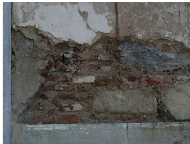
Figura 5.54 - Ausência de reboco na parede.
