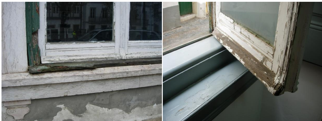
Figura 5.48 e 5.49 - Degradação da caixilharia.
