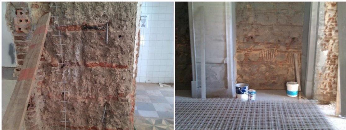
Figura 5.38 e 5.39 - Paredes com diferentes constituições.
