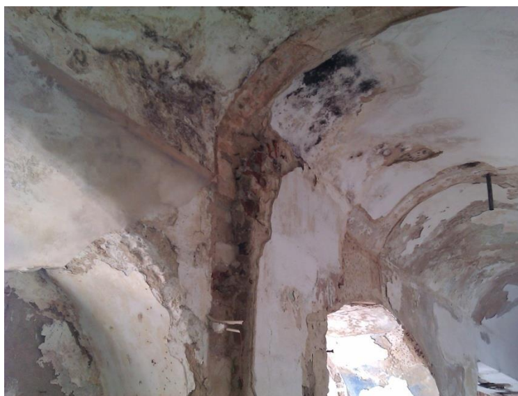
Figura 5.41 - Humidade devido a infiltrações de água.
