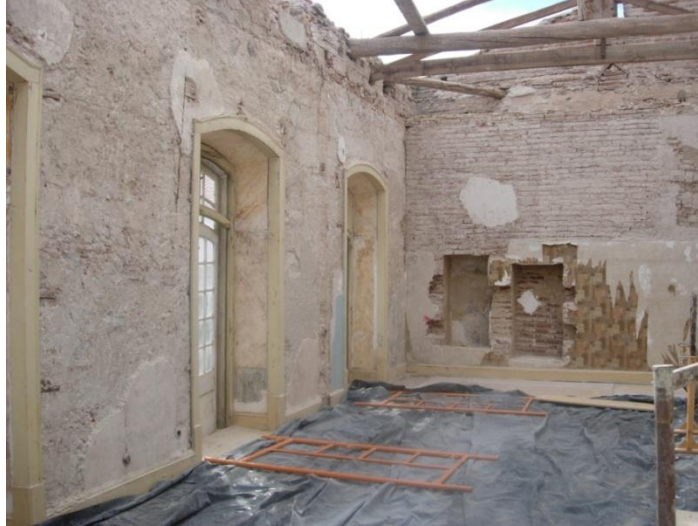
Figura 5.51 - Paredes sem reboco e antiga estrutura de madeira.
