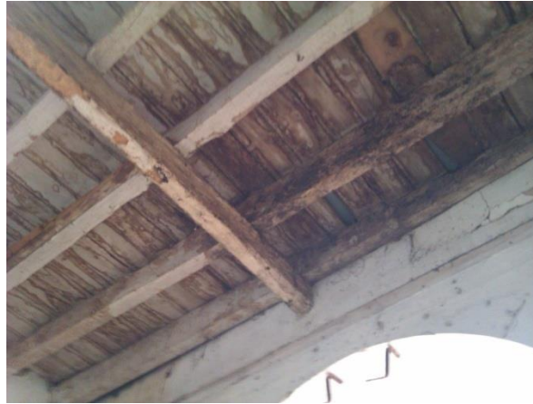
Figura 5.46 - Pavimento em condições deficientes.
