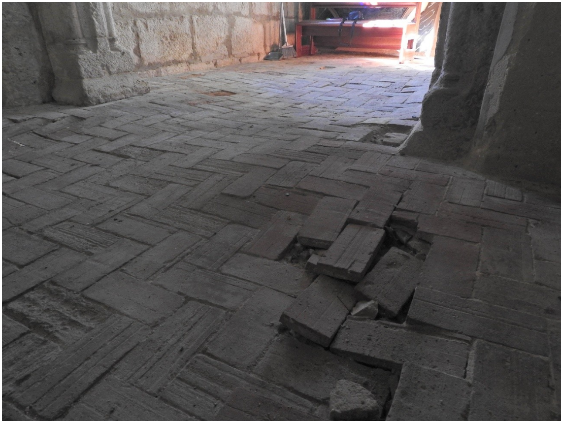
Imagem 7 - Abatimento do chão da Capela do Tesouro (autoria: Rita Balona)
