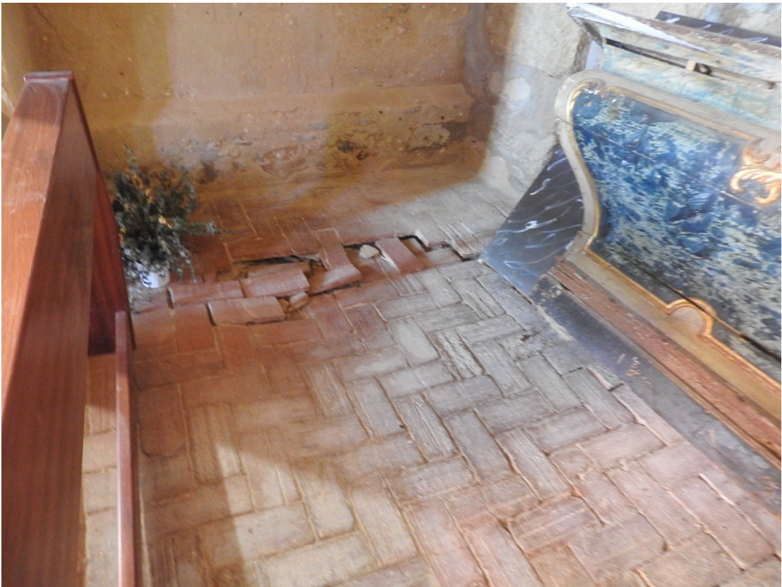
Imagem 8 - Abatimento do chão da Capela do Tesouro (autoria: Rita Balona)
