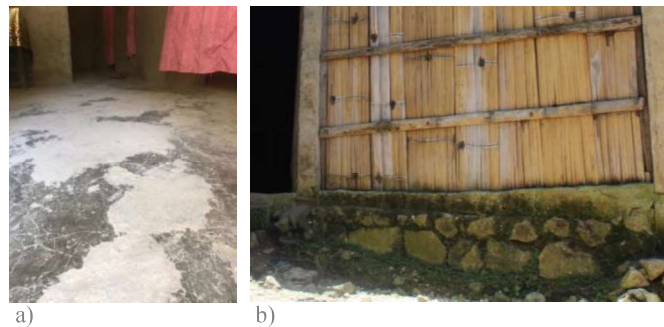
Figura 4- 56. Anomalias. a) Fenda no pavimento de betonilha b) Aparecimento de vegetação parasitária na alvenaria de pedra.
