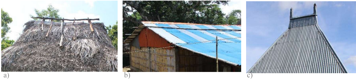
Figura 4- 40. Remates das coberturas. a) Remate da cobertura com fixação de madeira casa 7 b) Remate da cobertura com Chapa metálica casa 6 c) Remate da cobertura com chaminés casa 9.
