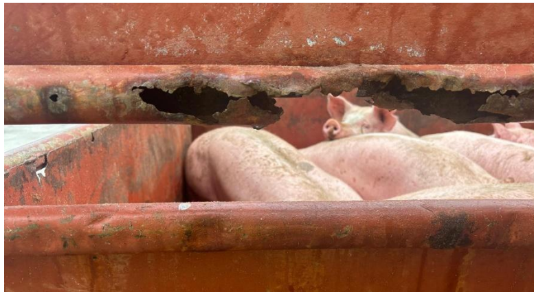
Figura 40: Buracos nos contentores do porto de São Roque (Fonte: Própria, 2024)
