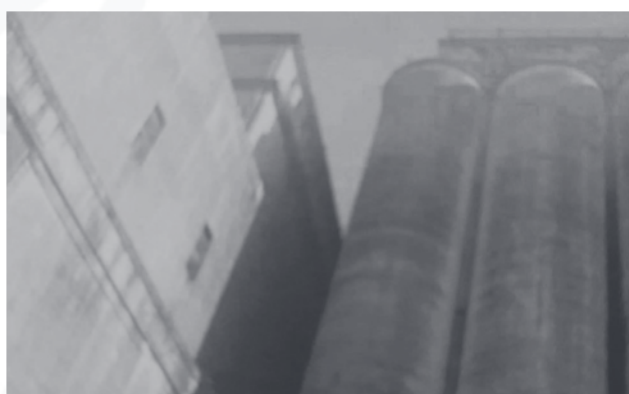
Figura 3. Estado de conservação dos silos. Fonte: Foto de Pedro Portugal, 2007.
