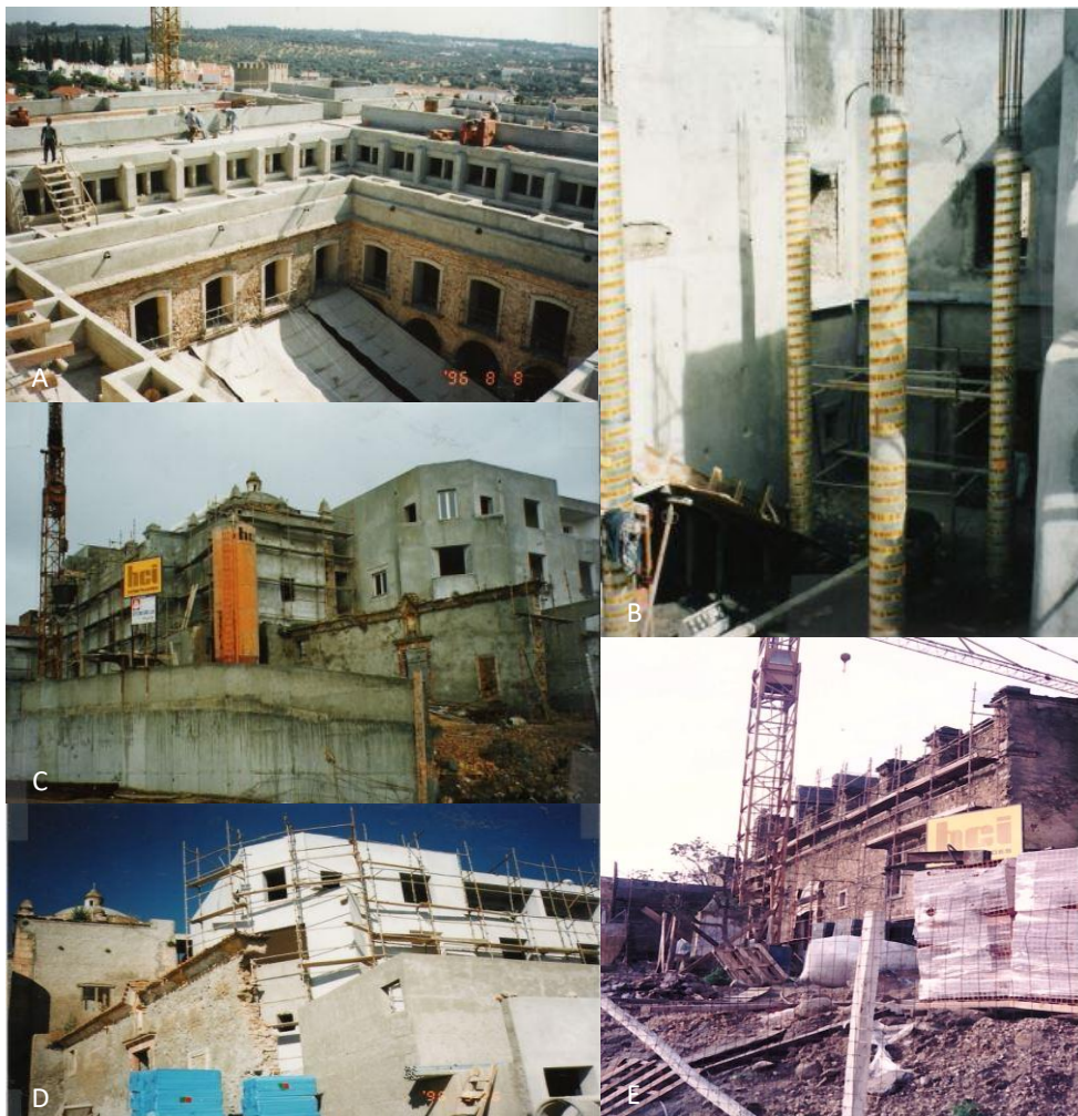
FIGURA 37- A CLAUSTRO / AMPLIAÇÃO; B RECONSTRUÇÃO DE UMA ZONA DO CLAUSTRO; C ARRANJOS NO MOSTEIRO; D NUMA FASE MAIS AVANÇADA. ARRANJOS NA ZONA NORTE DA Pousada; E RECONSTRUÇÃO DA ZONA LATERAL DA IGREJA.
