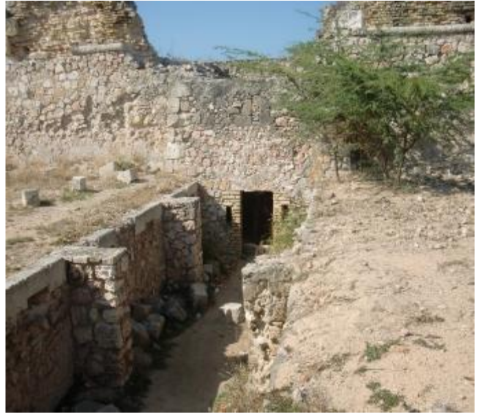
Figure 32- Plantes sauvages dans la structure du fort. Source : Archives ISPAN 2009.
