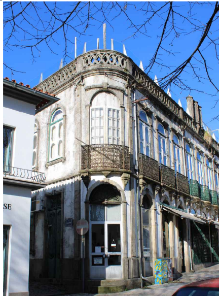
100. Edifício Xa-Xa-Xa, século XIX. Rua Bento Carqueja | Praça José da Costa. Ficha nº 15. ©Autora, 2018.
