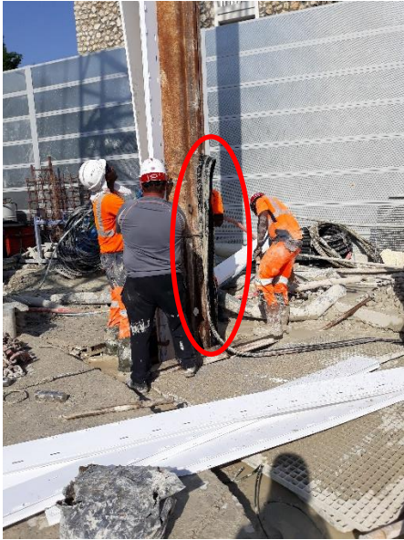
Figura 25 Junta CWS: Círculo a vermelho corresponde ao waterstop (filamento a preto em borracha).
