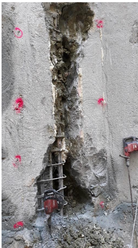
Figura 24 Lacuna no betão devido à falta de adesão do betão às armaduras, armadura aparente com vazio na parede moldada
