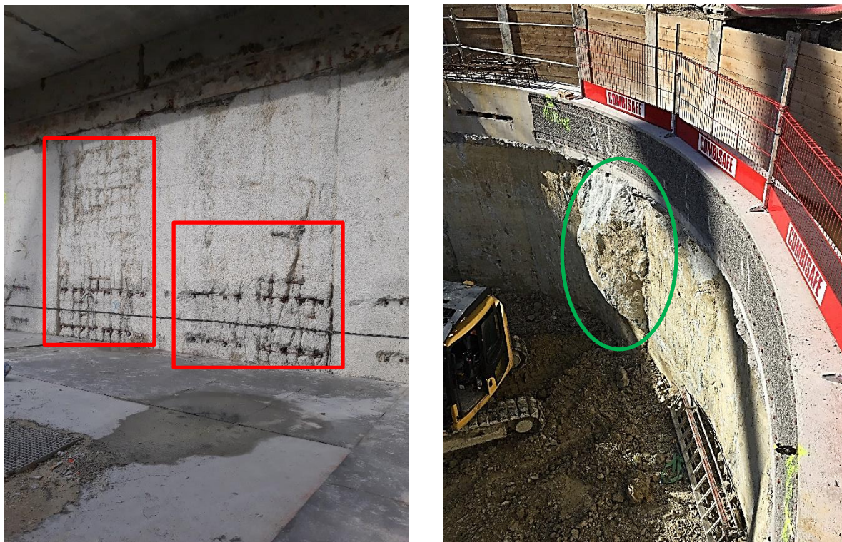
a) b) Figura 22 Problemas devido a falta de verticalidade no painel, em relação a direcção em Y: a) Painéis com as armaduras expostas (indicado com os quadrados vermelhos); b) "boça" de betão (consumo excessivo de betão, indicado pelo círculo verde).
