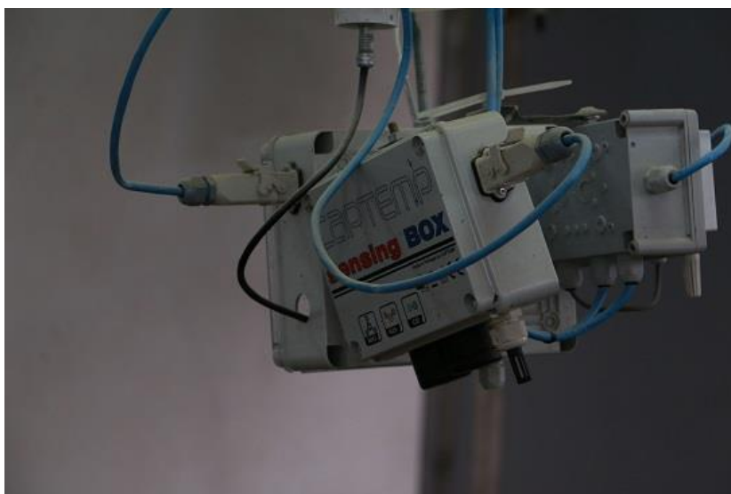
Figura 12 - Caixa sensorial para a medição da concentração de gases (Fonte: Elaboração própria)
