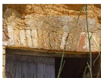
(c) travers des portes
