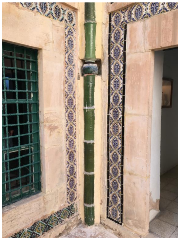
Tuyaux en céramique pour conduction des eaux de pluie avec dispositif de récupération de l'eau dans une maison de Sfax, Tunisie
