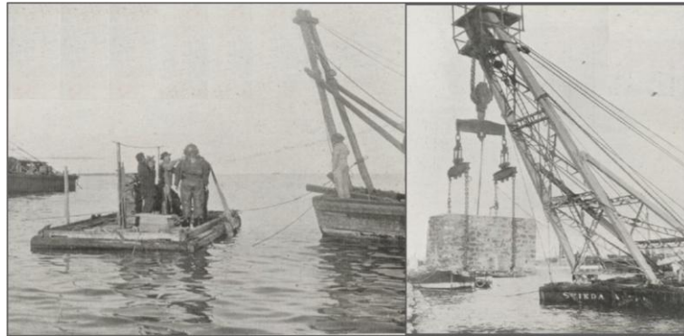
Figure 3.20 : Droite : Scaphandrier fixant l'emplacement des blocs, Gauche : Placement des blocs Source : la dépêche coloniale illustrée ....p51
