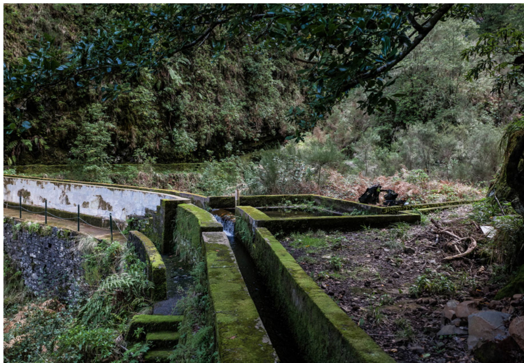
66 | Câmara para retenção de águas da levada da Serra do Faial
