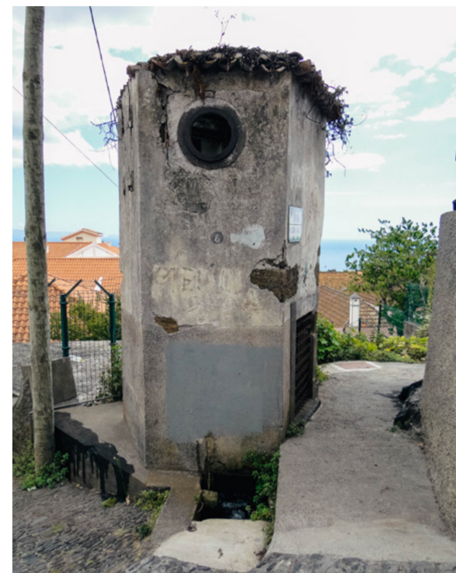
132 | Relógio de água da levada da Azenha, Caniço
