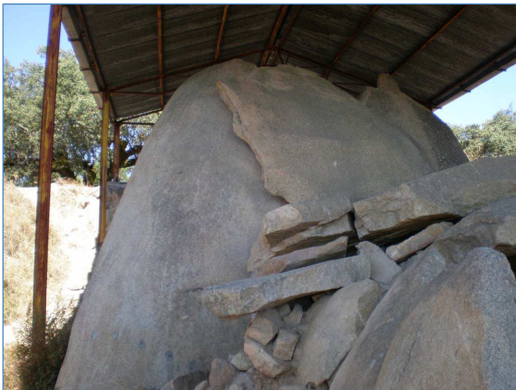
Figura 2. Pormenor de alguns dos problemas estruturais do monumento.
