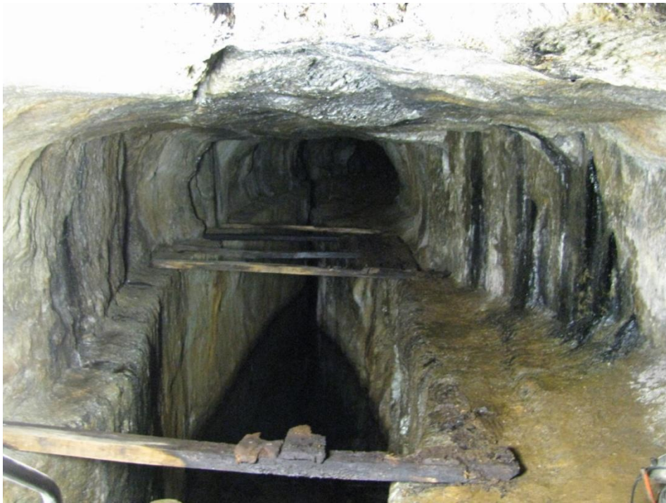
Foto 68 – Abatimento do canal da Galeria do Pilar, Corta de Covas, Tresminas
