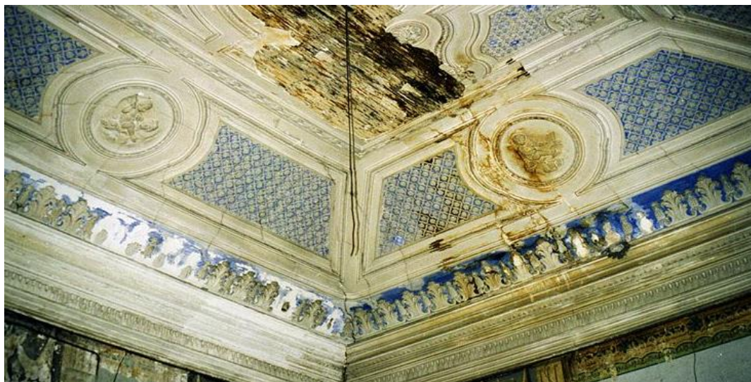
Figura 2 - Pormenor do estado de degradação do interior do Palácio Conde-Barão do Alvito. DGCP.
