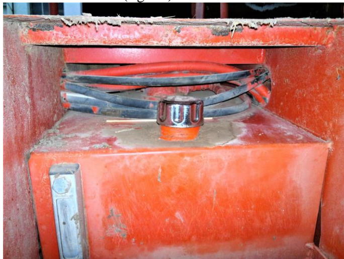
Figura 46 – Reservatório de óleo com o respectivo bujão de enchimento e visor de nível
