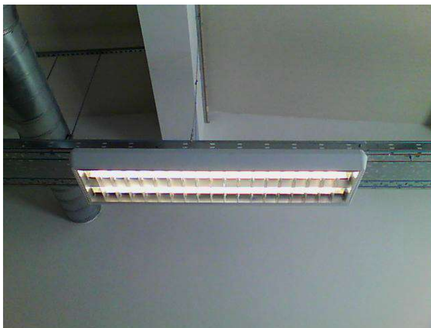
Figura 52: Equipamento de iluminação
