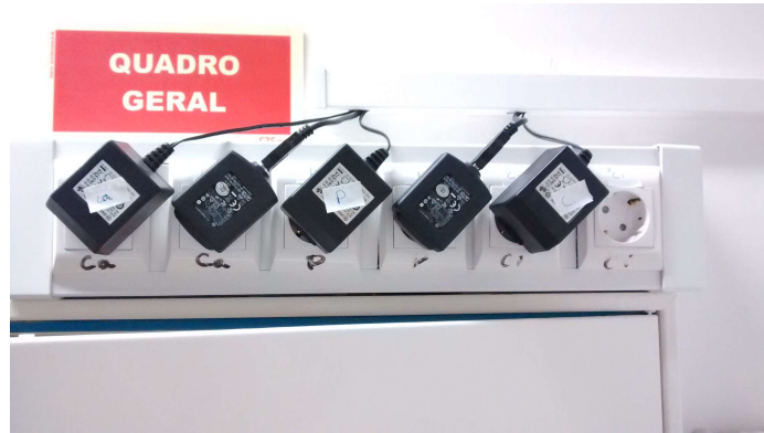
Figura 60: Transformadores para medição de tensão AC no quadro geral
