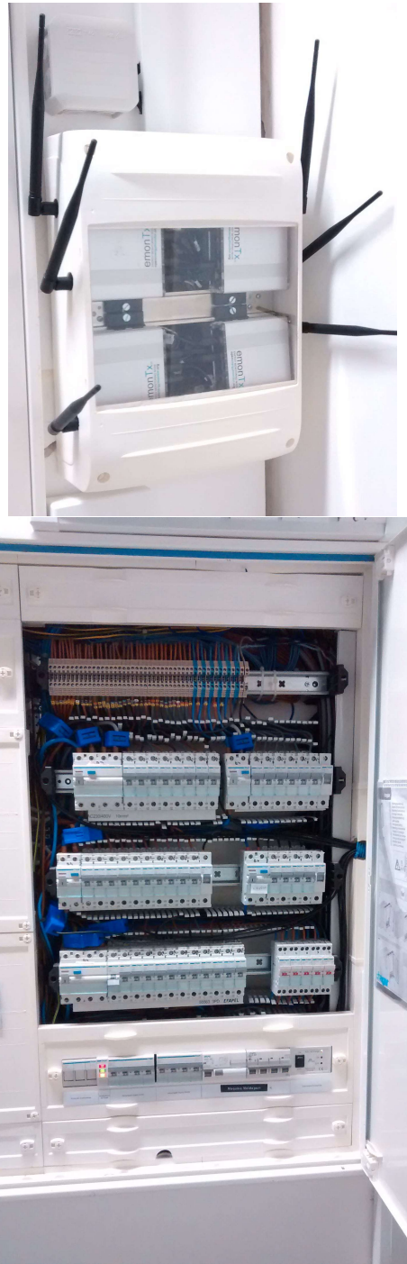
Figura 59: Instalação no quadro geral
