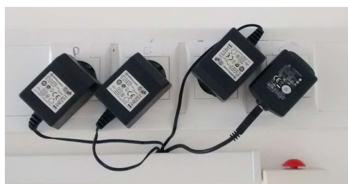
Figura 62: Transformadores para medição de tensão AC no quadro parcial
