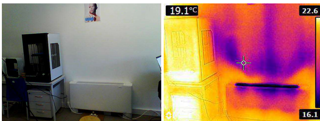
Figura 49: Foto térmica da Sala 3 - Unidade térmica
