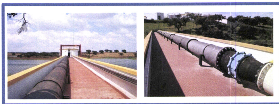
Figura 15: Conduto da elevação da água bruta.
