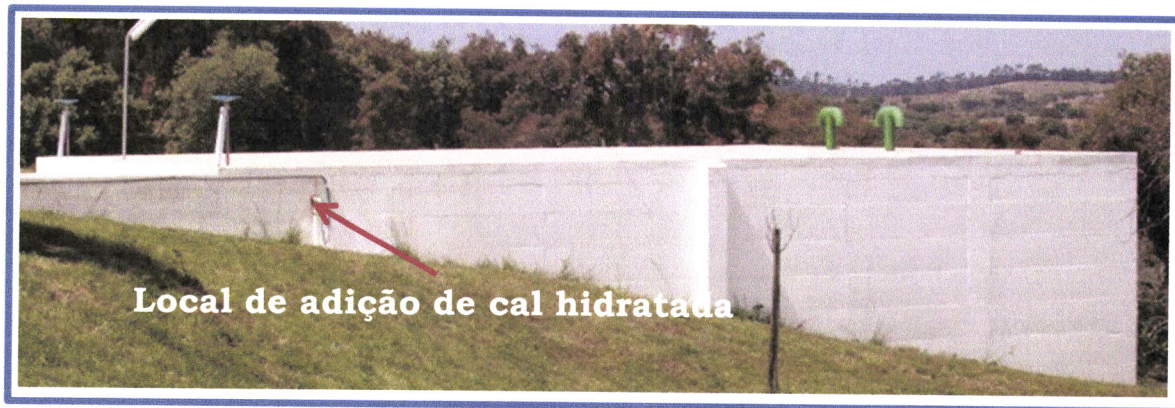
Figura 27: Cisterna de contacto com o cloro.
