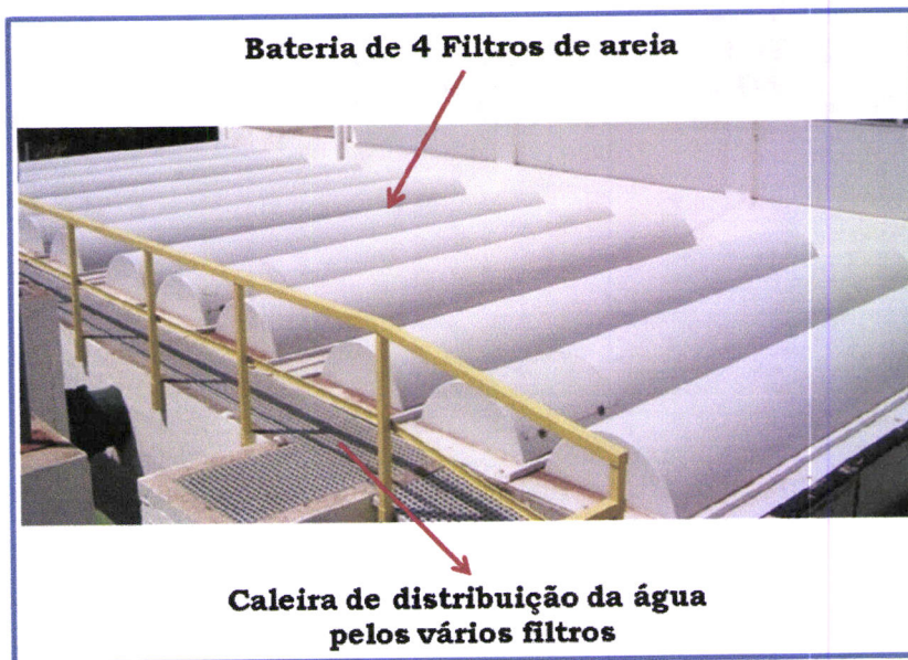
Figura 26: Filtros de areia.
