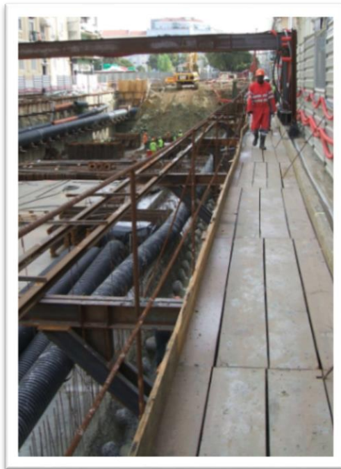
Figura 7 - Suspensão de coletores através de cabos presos a perfis metálicos - Obra de ampliação da estação Saldanha, 2006 Fonte: Base de dados da empresa Ferconsult
