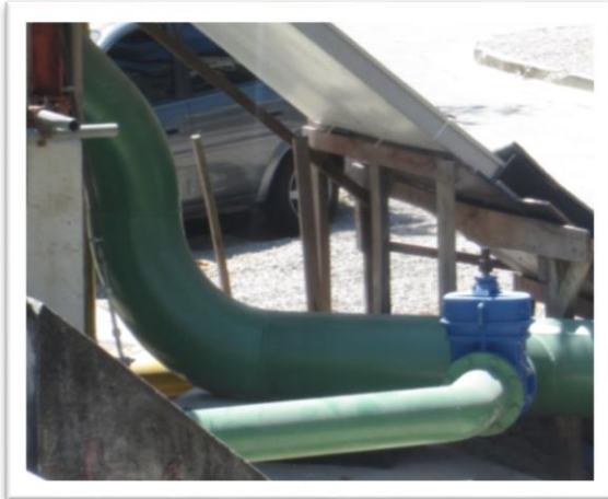
Figura 22 - Pormenor de válvula em conduta desviada
