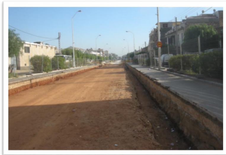
Figura 25 - Terraplenagem para permitir a execução da plataforma do Metro ligeiro - Obra Metro Sul do Tejo - Almada
