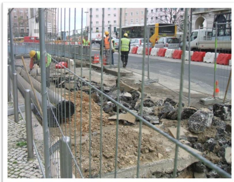
Figura 33 - Desvios de trânsito na Remodelação da Estação Areiro para permitir os desvios das infraestruturas - Obra de remodelação da Estação Areiro Fonte: Base de dados da empresa Ferconsult
