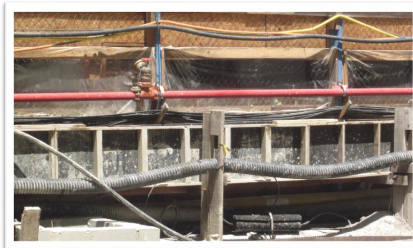
Figura 24 - Suspensão física de condutas de cabos de telecomunicações e da rede de incêndios dentro do estaleiro.
