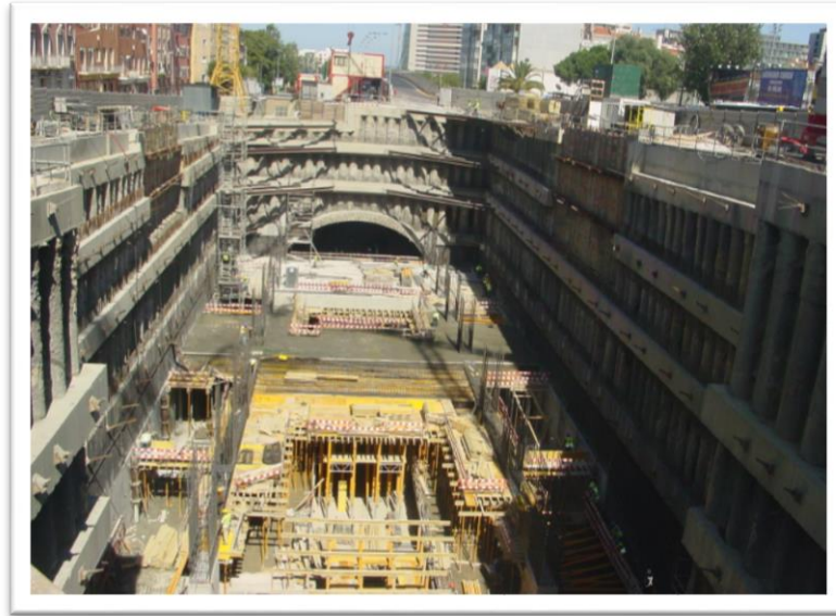
Figura 30 - Construção da Estação Moscavide -Obra da estação Fonte: Base de dados da empresa Ferconsult
