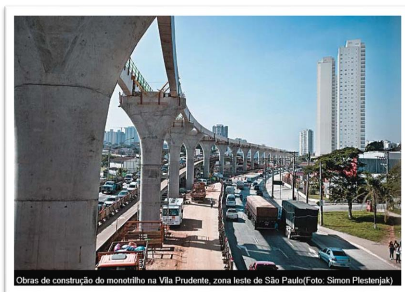
Figura 17 - Imagem da construção da via em Monotrilho Fonte: Jornal Época de São Paulo Vida Urbana - 17/08/2012, consultado em 2014/06/26 (edição on-line )
