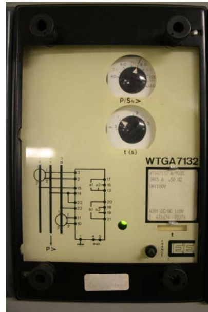
Figura 19 – Protecção WTGA7132 (sobrepotência)
