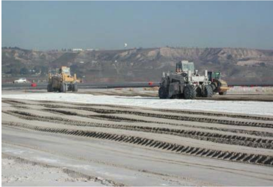
Figura 2.4 - Trabajos de estabilización, con recicladoras sobre plataforma de gran superficie (Guía Técnica, 2013).
