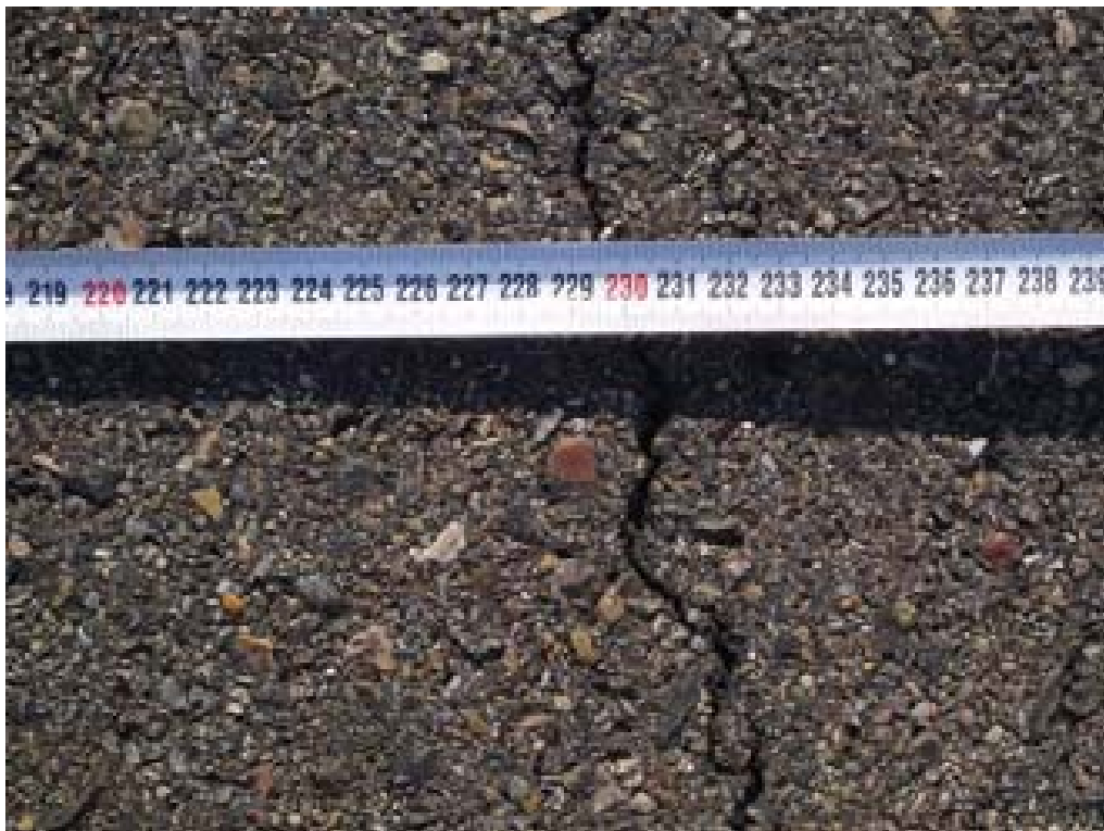
Figura 4.51 - Fisuras aparecidas por falta de solape en la construcción.
