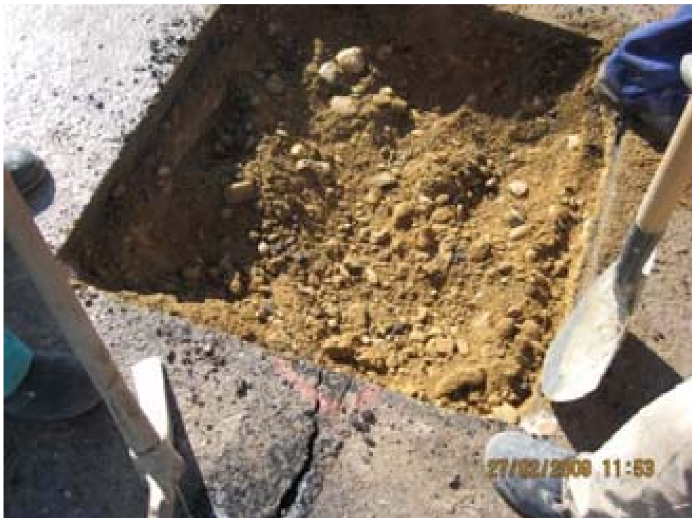
Figura 4.50 - Fisuras aparecidas por fallo de algún inyector y calicata de comprobación.
