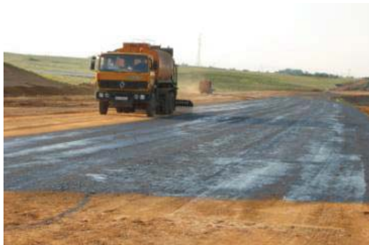
Figura 2.15 - Riego con emulsión de la superficie terminada, este paso debe realizarse poco tiempo después de realizar los trabajos de mezclado, refino y compactación.
