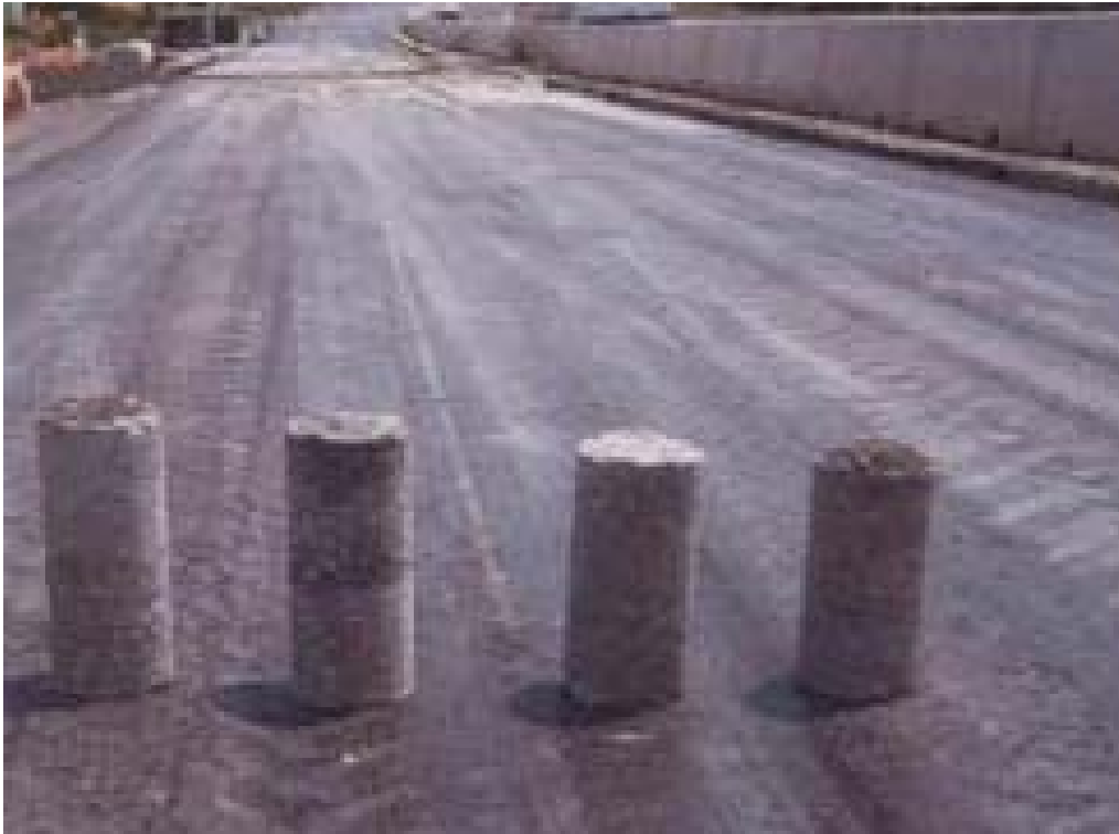
Figura 4.28 - Testigos de hormigón compacto – 4% cemento. Autopista del Cantábrico.
