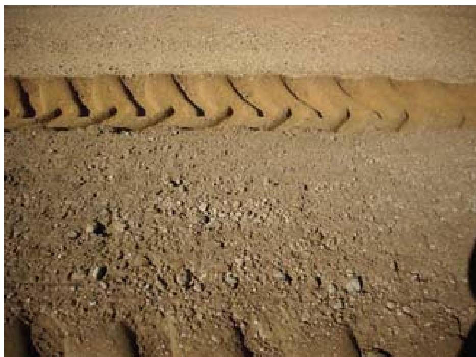
Figura 4.40 - Detalle de suelocemento realizado in situ , antes de su compactación y refinado.
