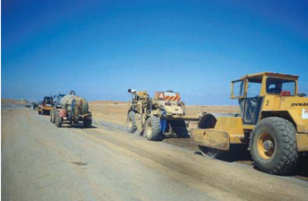
Figura 2.7 – Compactación de la capa estabilizada, después de tratado con la Wirtgen (Guía Técnica, 2013).
