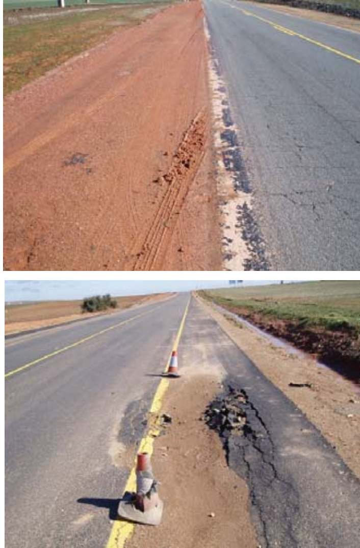
Figura 4.39 - Suelos muy plásticos, empleados en la realización de un fallido suelocemento in situ .
