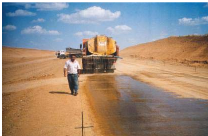
Figura 2.14 - Riego con agua, de la superficie compactada, paso realizado para el buen curado de la misma.
