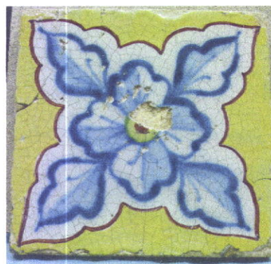
Figura 6 – Azulejo cujo fendilhamento resultou num destacamento mais
