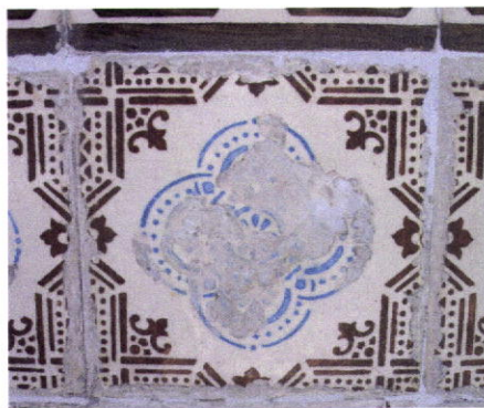
Figura 44 – azulejo com falhas de vidroado
