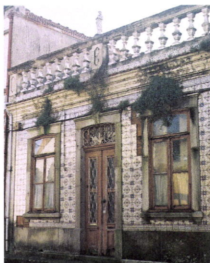
Figura 30 – Fachada que apresenta uma prolongada exposição à água
