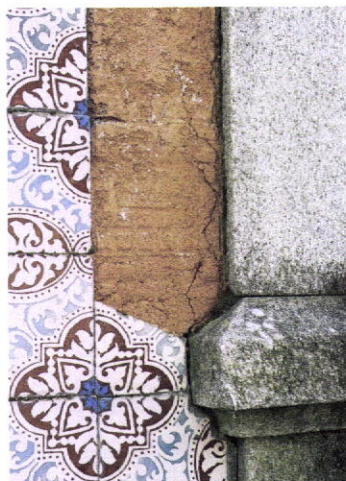
Figura 26 – Fendilhação ao nível dos azulejos e da camada de assentamento
