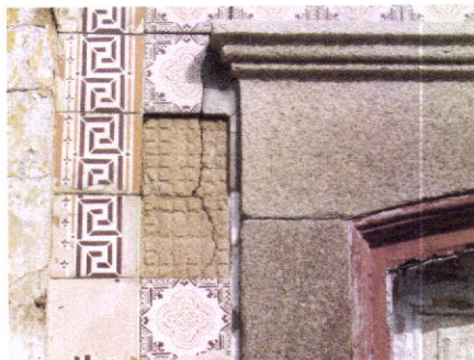
Figura 27 – Fendilhação ao nível do suporte e da camada de regularização
