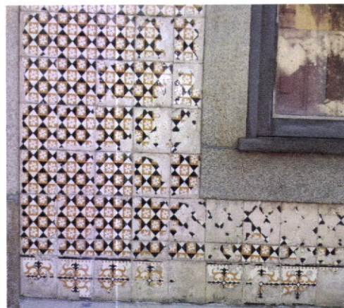
Figura 28 – Pormenor de azulejos com destacamento de vidrado
