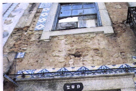
→ Zona de destacamento, orifícios e sujidades diversas
