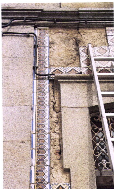
Figura 22 – Pormenor de fendilhação do suporte
