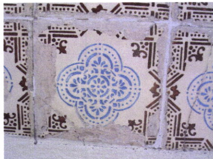
Figura 29 – Lacuna de vidro nas zonas de contacto entre os azulejos
