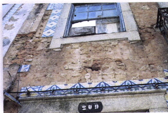
→ Zona de destacamento, orifícios e sujidades diversas
