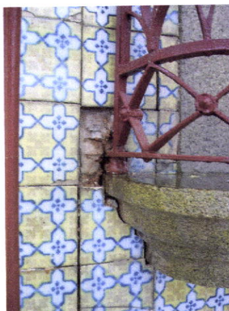
Figura 24 – Destacamento devido às aplicações metálicas da varanda
