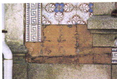
Figura 23 – Destacamento de azulejos causado por excesso de humidade
