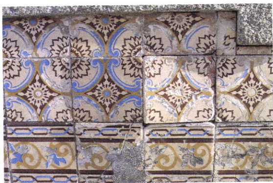
Figura 25 – Pormenor de um conjunto de azulejos descolados e desprendidos
