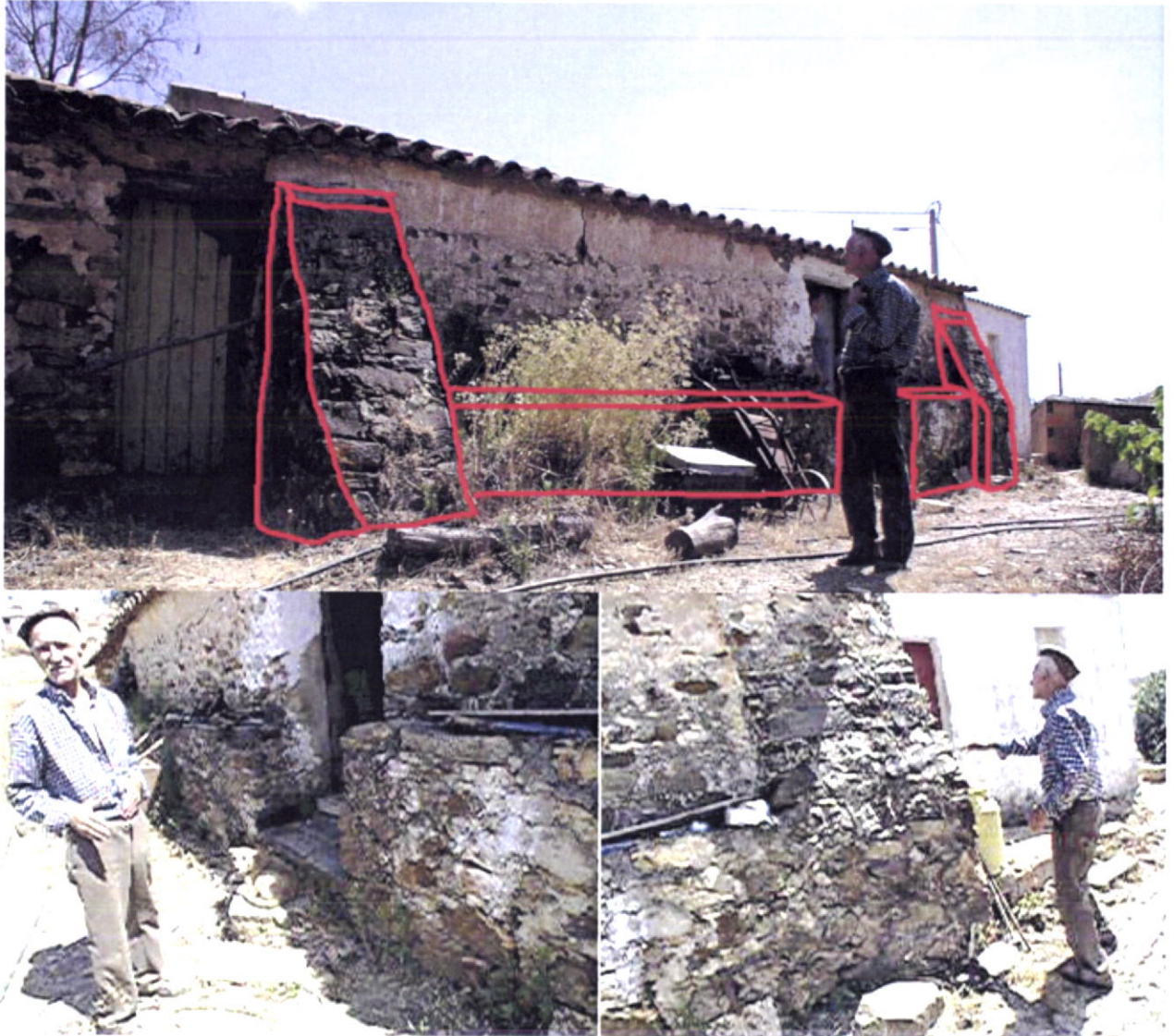
Fig.184-Vista geral de uma reparação de uma habitação com recurso as três técnicas (Contrafortes, enchimento e reforço da base com poial alto). Pormenores da dimensão do poial e do contraforte, comparativamente com a estatura de um homem. Cancino.
