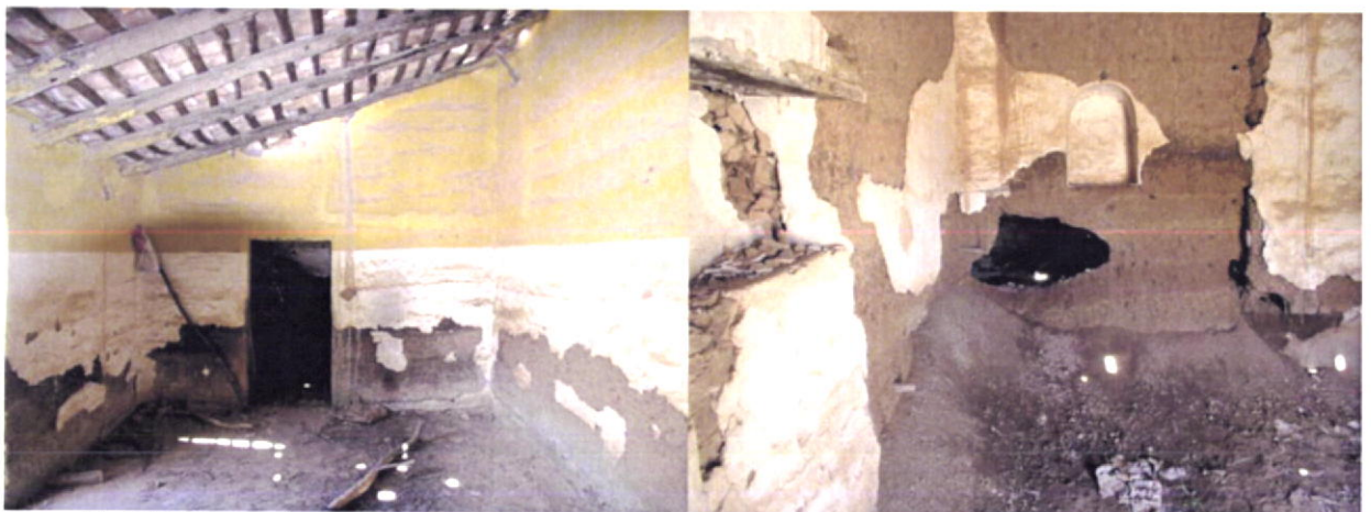
Fig.224-Vista da ascensão capilar em paredes resistentes e interiores. Em paredes divisórias, em muitos dos casos o assentamento era realizado directamente sobre o terreno, pelo que é frequente este tipo de patologia nestes elementos.
