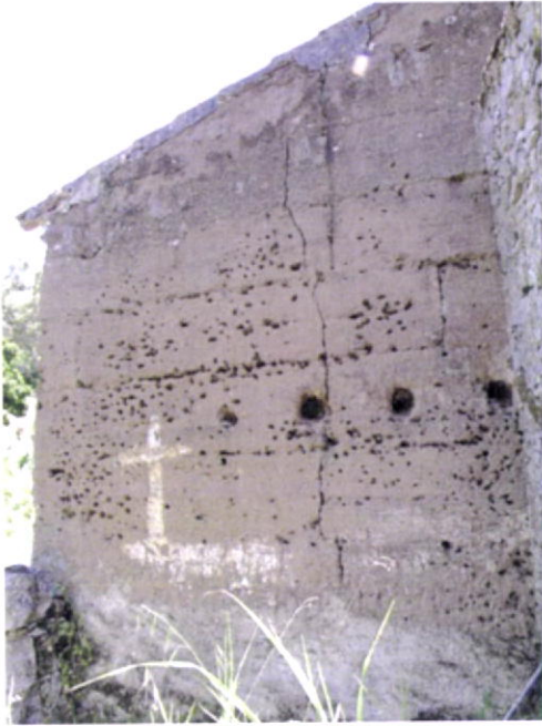
Fig.232-Orifícios escavados por insectos, na parede norte.
