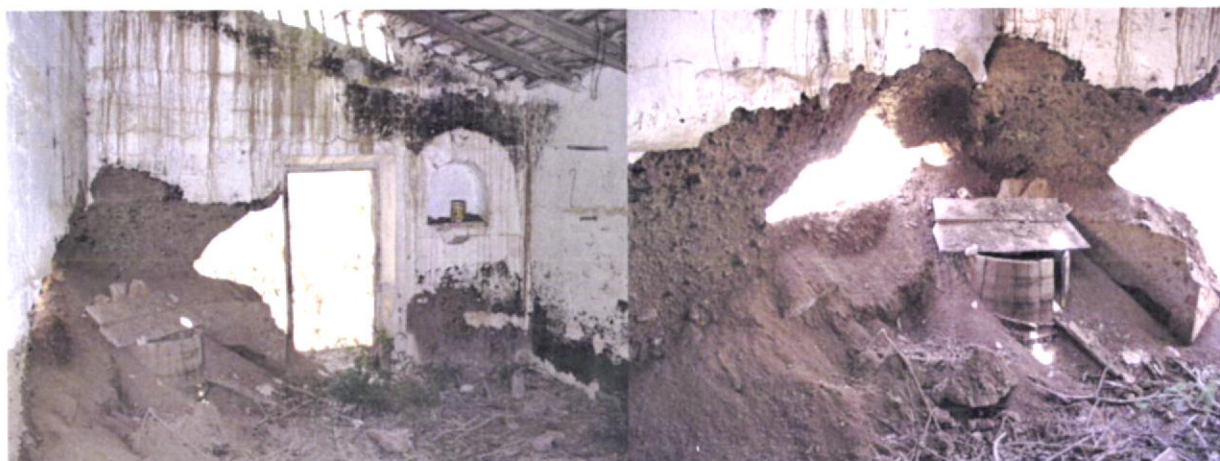
Fig.226-Caso de degradação da taipa, por efeito de escorrência de água da chuva através do telhado. Na mesma parede, observa-se ainda o efeito num do canto da habitação, da proximidade de uma vala de recolha de águas pluviais que se localiza junto à mesma.
