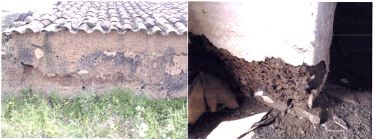
Fig.223-O desprendimento do reboco assinala de um modo geral os primeiros sinais de humidade localizada. Com o decorrer do tempo, e em situações continuada, de ascensão de humidade a taipa perde resistência e consistência, originando-se perdas consideráveis de taipa, que se liberta em sucessivas camadas da parede.
