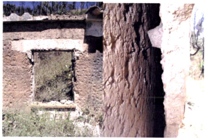
Fig.121-Observe-se a picagem de parede de taipa para melhoria da aderência do reboco de cal ao suporte. Vista de reboco a descolar de suporte de parede picada e sem juntas de cal e areia (direita). Passil.
