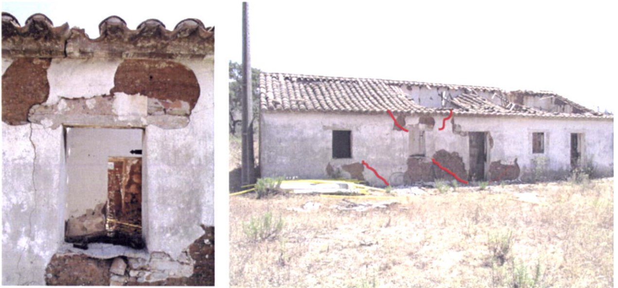
Fig.193-Do calculo, observa-se que nas zonas de vão, a fissuração com uma orientação de 45° com a vertical, têm origem em tensões de corte que surgem junto à base de portas e no topo junto a verga.
