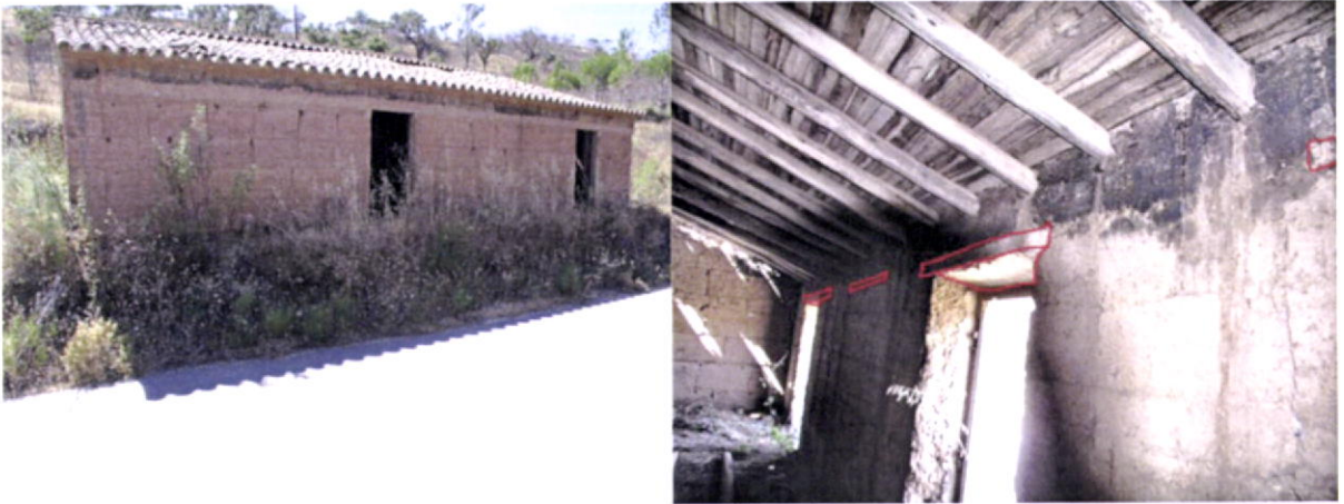
Fig.118-Vista exterior e interior de viga em betão armado em construção de taipa. Romeiras.
