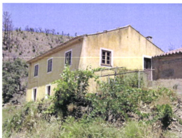
Fig.154-Vista de edificação onde se observa a inclinação dada durante a construção da parede da fachada principal. Panasqueira.
