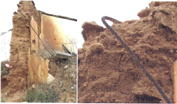
Fig.178-Pormenor de reforço da parede central em taipa, com aplicação de cabo de aço . Albufeira.
