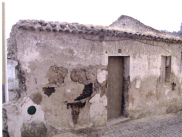
Fig.27-Vista de ruína de casa, executada em taipa negra. Monchique.
