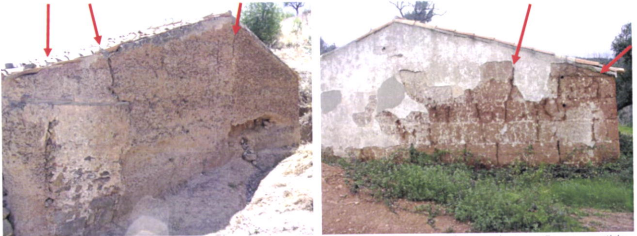
Fig.202-Mais um exemplo de fissuração em cunhais e a meio vão, por esforços de tracção no sentido horizontal da parede.
