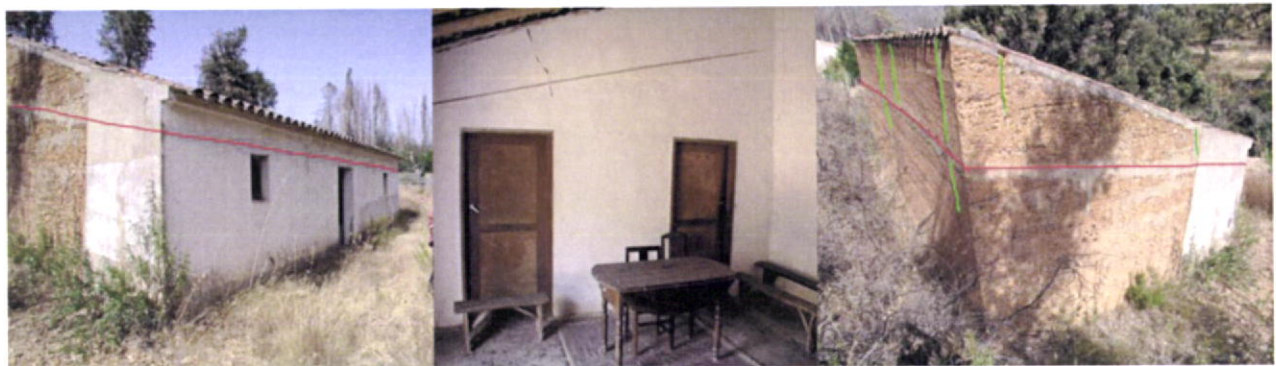
Fig.176-Pormenor de aplicação conjunta de linhas e esticadores junto das paredes divisórias (linhas a vermelho e fissuração a verde). Foz do Farelo.
