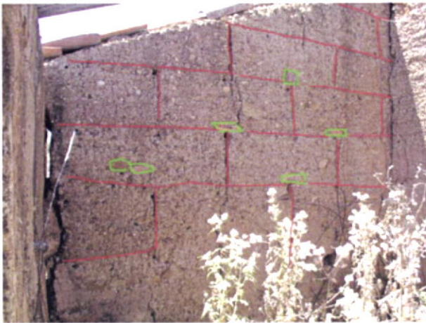
Fig.127-Pormenor do uso de pedras para matar as juntas verticais da taipa. Tojeiro.
