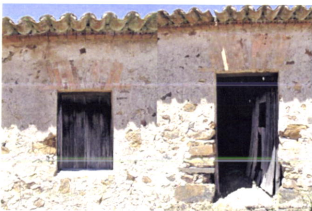
Fig.88-Pormenor de vão guarnecido com tijolo, em paredes de alvenaria de pedra. Vista de modelo de
