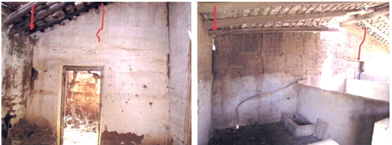
Fig.199-Pormenor do desligamento entre paredes com maior incidência no topo das paredes, devido a tensões de tracção e de corte. Observe-se ainda, o efeito de tensões de corte \sigma_{12} sobre os vãos.
