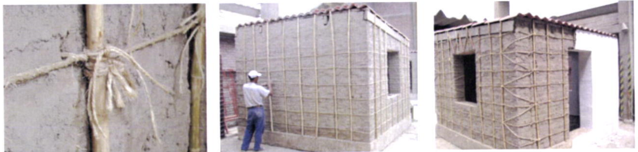
Fig.205-O Modelo 1, foi reforçado exteriormente na verticalmente com canas fixas entre si horizontalmente, e presas à parede com corda de fibras naturais. O modelo ensaiado foi parcialmente revestido com reboco, para análise da influência da argamassa na resistência sísmica (foto à direita).
