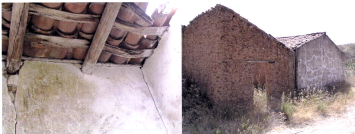
Fig.225-A origem deste tipo de patologia resulta do mau estado dos telhados e das caleiras dos telhados.
