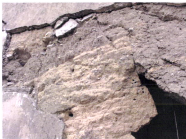
Fig.29-Taipa com solo de granulometria uniforme que evidencia falta de seixo. Monchique.
