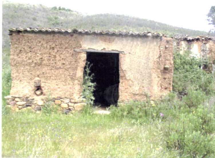
Fig.228-Parede de taipa onde se observa o efeito da chuva numa parede que perdeu a sua camada protectora em reboco e uma zona de maior erosão junto à base da parede com aproximadamente 1.50m de altura que onde ocorre o efeito de impacto directo das gotas de chuva sobre a taipa.
