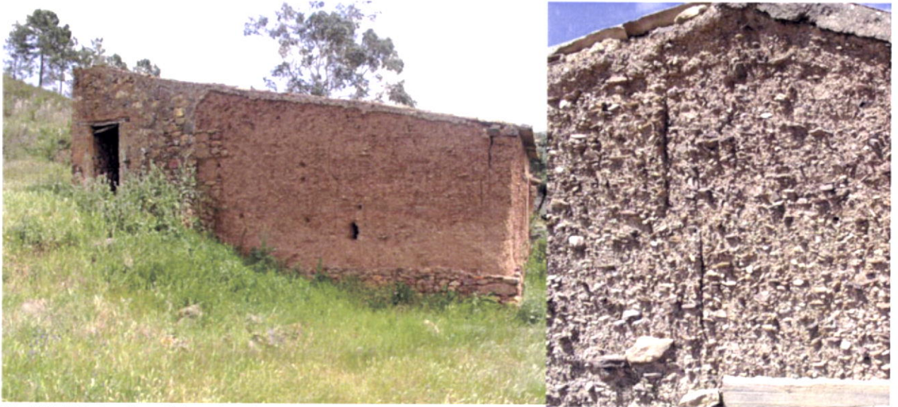
Fig.227-Vista do efeito da chuva numa parede que perdeu a sua camada protectora em reboco. Observe-se a perda de material nas zonas com e sem reboco.
