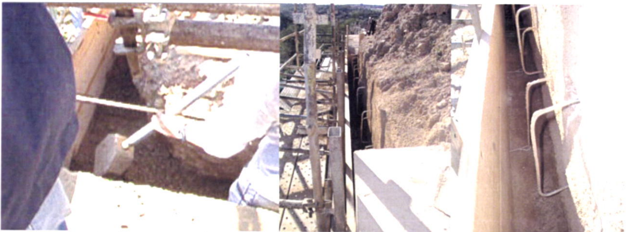
Fig.252-Exemplo da compactação manual com recurso a maço e exemplo de conectores em aço inoxidável, para interligação entre duas taipas. Castelo de Paderne 21/12/2004.
