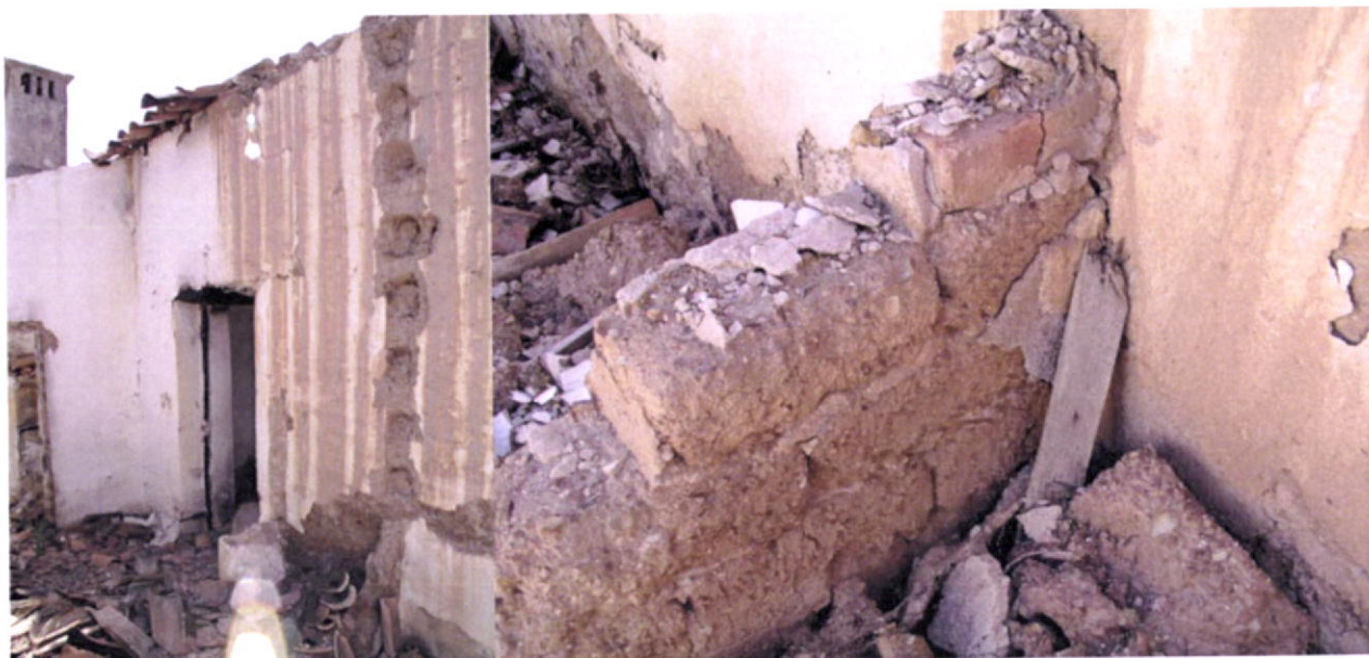
Fig.97-Pormenor da ligação de uma parede de adobe com as paredes resistentes. Observe-se a utilização de tijolos maciços cozidos. Passil, Monchique.
