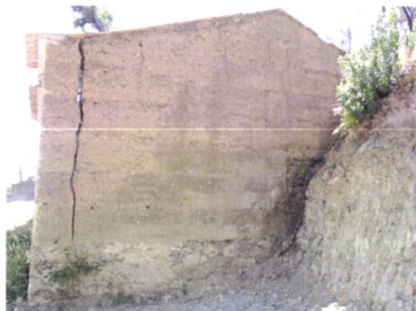
Fig.153-Pormenor de fissuração típica em cunhal, provocada por deslizamento da cobertura ou por abalo sísmico. Portela da Viúva.
