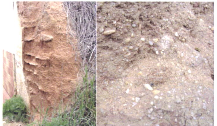
Fig.157-Exemplo da aplicação de camada de argamassa sobre cada camada de solo compactado, em reforço de um solo arenoso. Albufeira.
