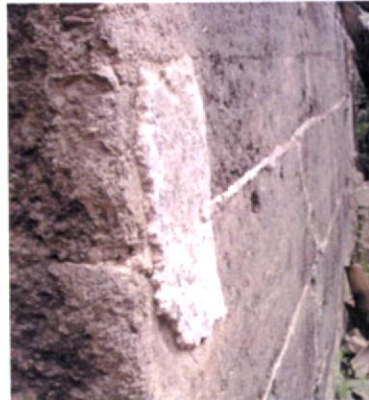
Fig.71-Pormenor de melhoramento da aderência ao reboco, por aplicação de juntas de cal entre taipais.
