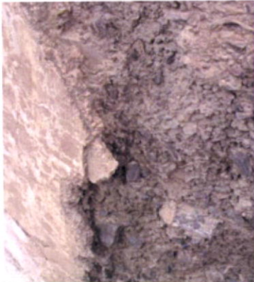
Fig.70-Pormenor de reboco composto por duas finas camadas.
