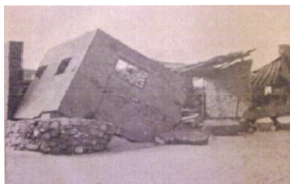
Fig.187-Exemplo do desprendimento de uma parede de taipa, após acção do temporal de Fevereiro de 1970, na praia de Quarteira. Fonte: Algarve Ilustrado, Fevereiro de 1970
