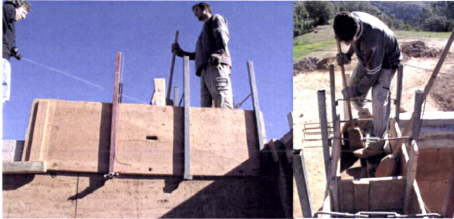
Fig.101-Pormenor de taipais utilizados recentemente na construção de casas de taipa nos Troviscais, Odemira.
