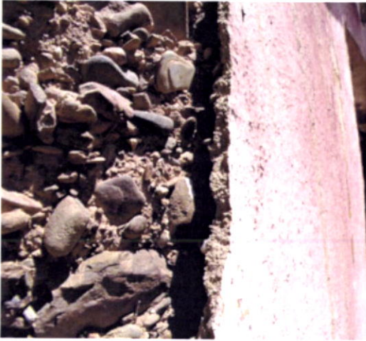
Fig.120-Pormenor da superfície de contacto com o reboco, de uma parede que ficou exposta à chuva. Corte.
