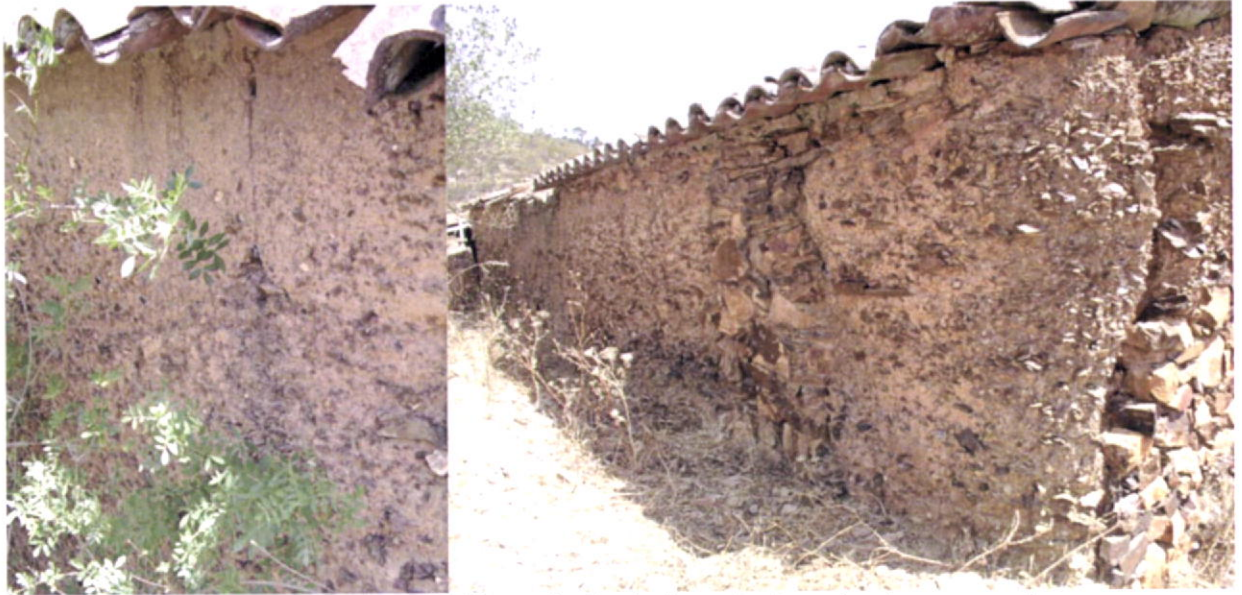
Fig.229-Pormenor da diferenciação de degradação entre duas zonas da parede em que uma delas é protegida da chuva pelo seu beirado.
