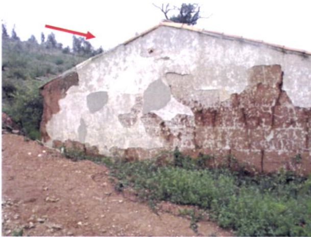
Fig.172-Exemplo de aplicação de esticador lateralmente à parede mestra central, para impedir a rotação das paredes laterais. Marmelete
