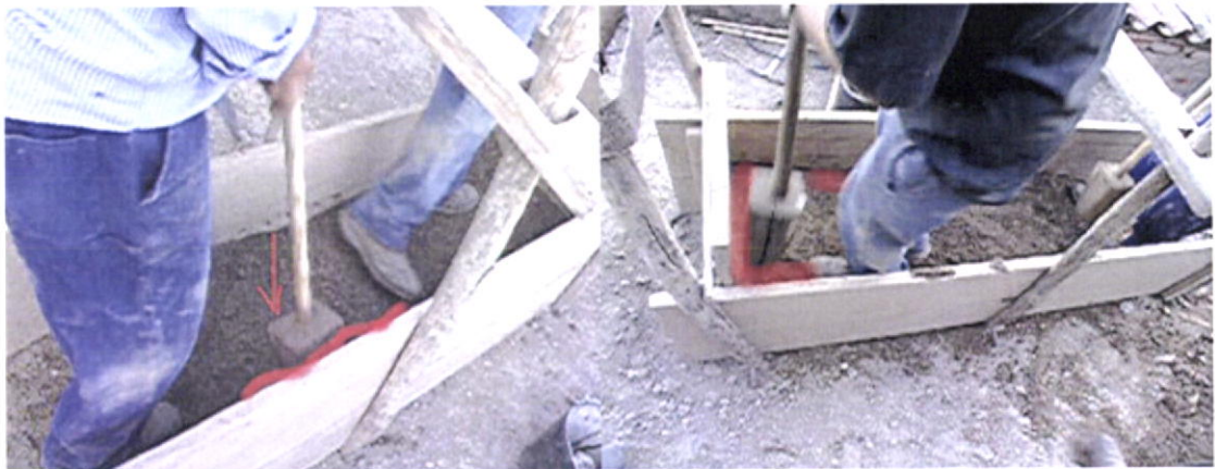
Fig.105-Cada camada, é primeiro compactada junto aos taipais e só depois batida ao centro. Monchique.
