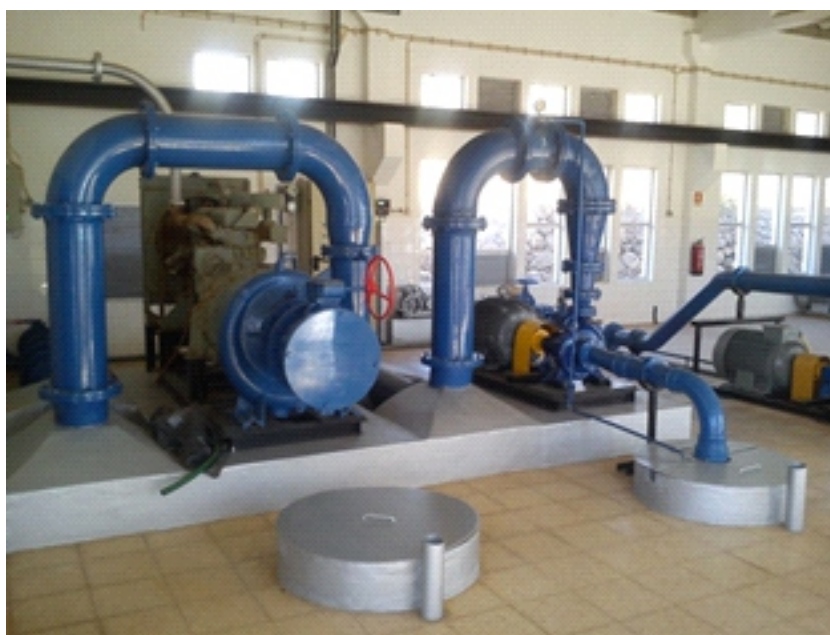
Figura 3.4 - Central elevatória de Figueira © Cristiano Gregório (2014)
