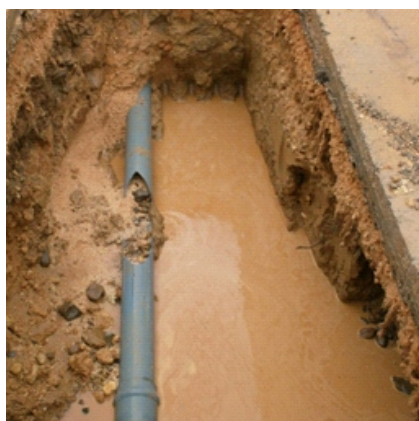
Figura 2.1 - Ruptura em Conduta de Distribuição DN160 © EMARP (2013)
