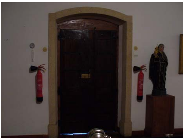
Foto 21 - Sistema de controlo ambiental e extintor. (dezembro de 2006)
