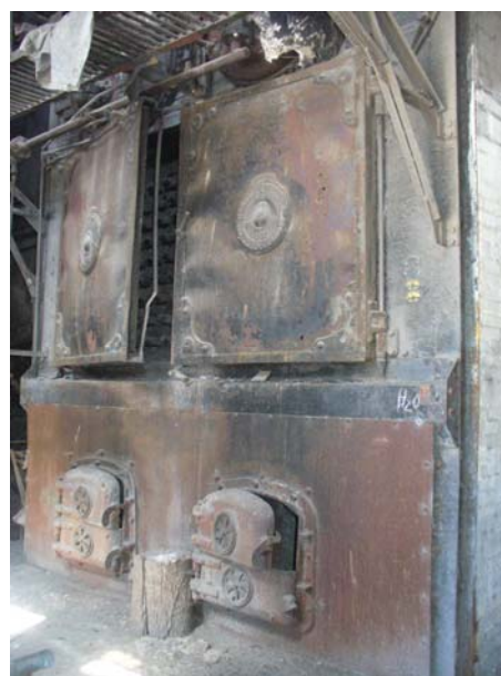
Foto 121 - Caldeiras a vapor (agosto 2012)
