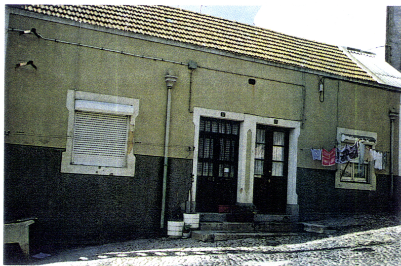
Fot. 50 a 52 - Descaracterização do Edificado, Largo D. Diniz e Calçada do Tojal
