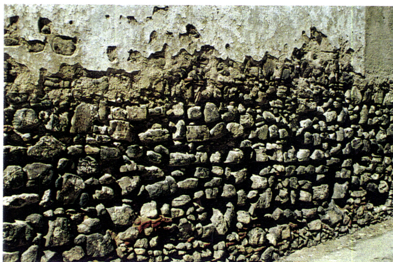
Fot. 53 a 55 - Edifícios em Mau Estado de Conservação - Rua da Fonte
