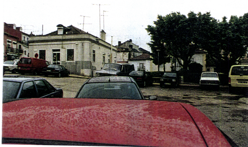
Fot. 59 a 61 - Deterioração do Edificado e do Espaço Urbano (Largo D. Diniz)
