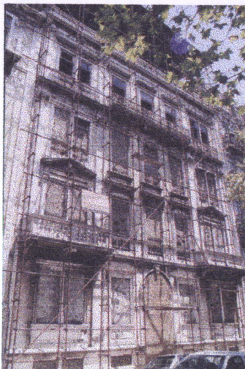
Fig. 133 O estado de degradação do imóvel sito na Avenida da Liberdade, n.º 238.
