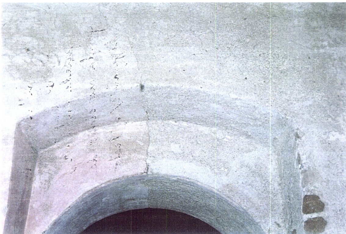
Fig. 9.20 – Igreja de S. Francisco de Évora. 5º tramo da galeria Sul: fenda no arco de ligação com o sexto tramo
