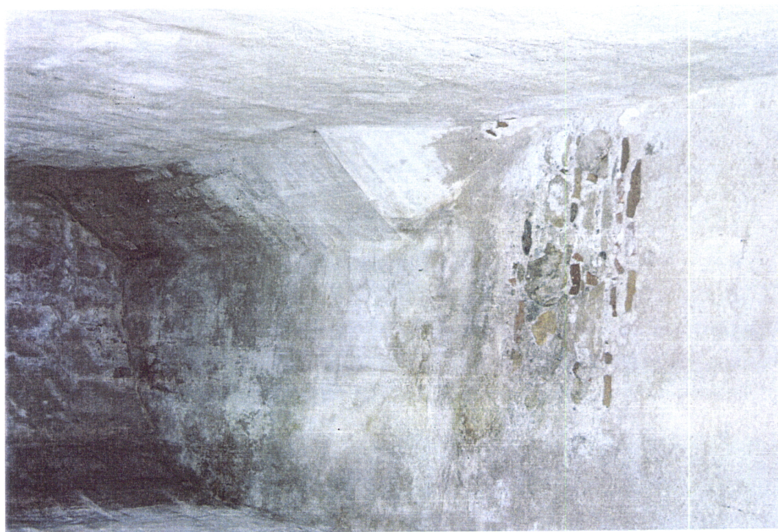
Fig. 9.24 – Igreja de S. Francisco de Évora. 2º tramo da galeria Norte: humidade e degradação do reboco das paredes e abóbada
