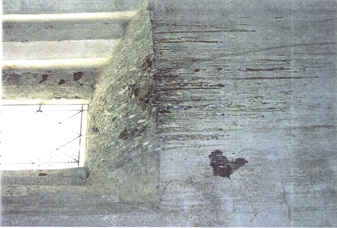
Fig. 9.28 – Igreja de S. Francisco de Évora. 3º tramo da galeria Norte: deposição de guano de pombo no parapeito da fresta exterior
