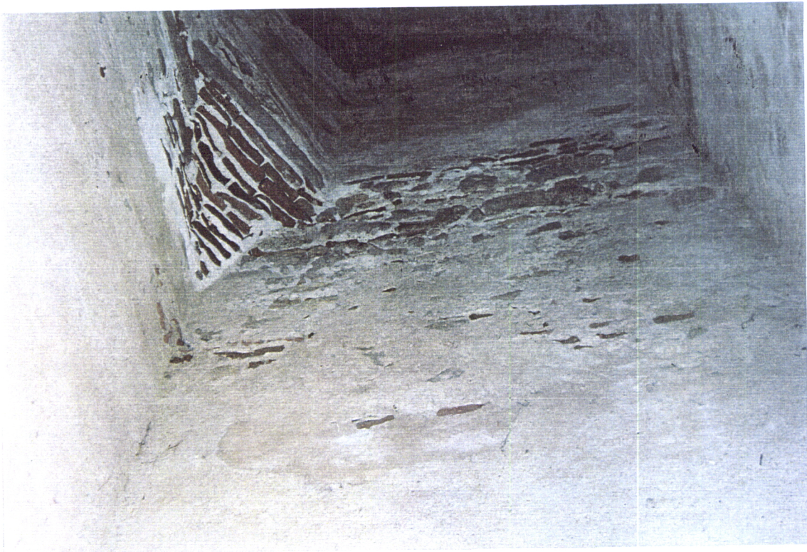
Fig. 9.22 – Igreja de S. Francisco de Évora. 1º tramo da galeria Norte: degradação do reboco das paredes
