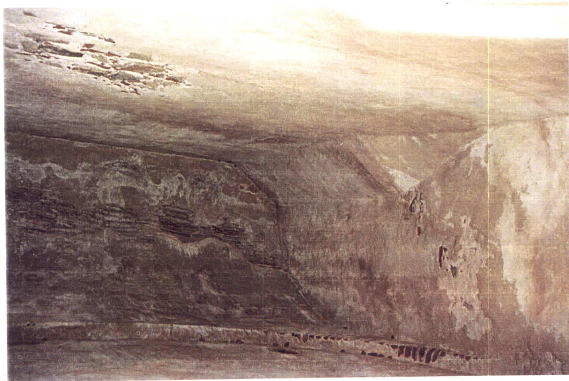
Fig. 9.13 – Igreja de S. Francisco de Évora. 2º tramo da galeria Sul: degradação dos rebocos da parede e abóbada
