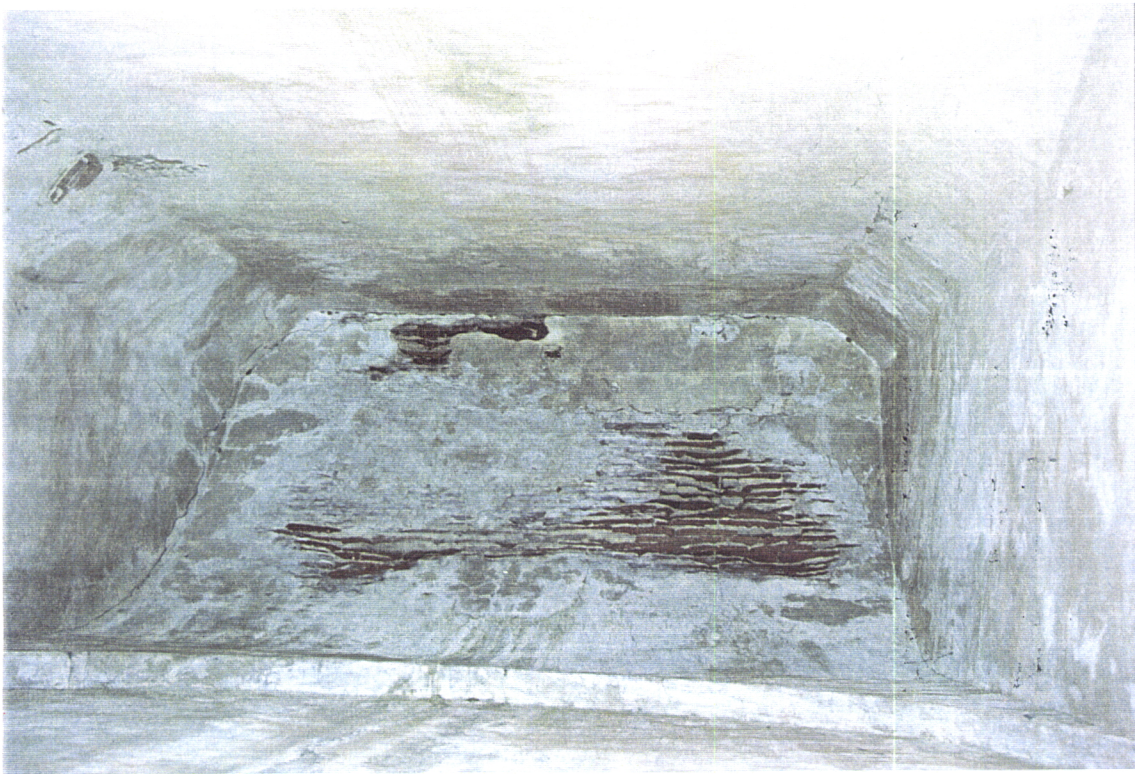
Fig. 9.19 – Igreja de S. Francisco de Évora. 5º tramo da galeria Sul: manchas de humidade e degradação do reboco, com tijolo à vista na abóbada
