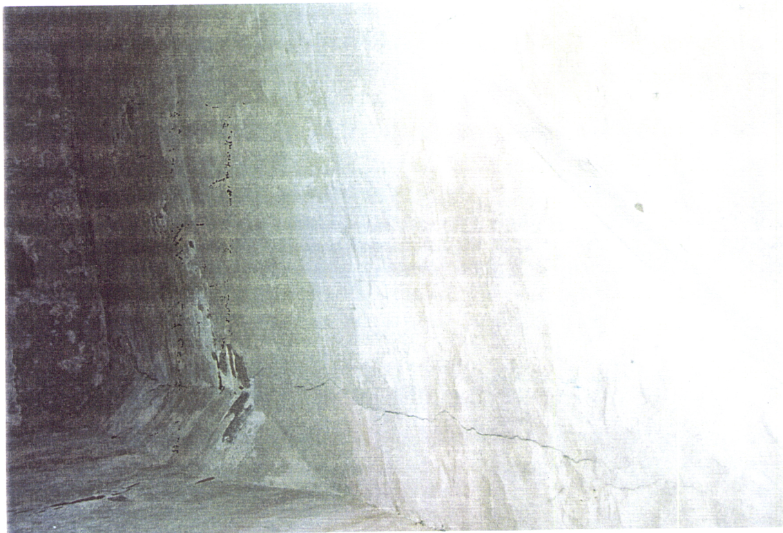
Fig. 9.16 – Igreja de S. Francisco de Évora. 3º tramo da galeria Sul: fenda vertical na parede interior
