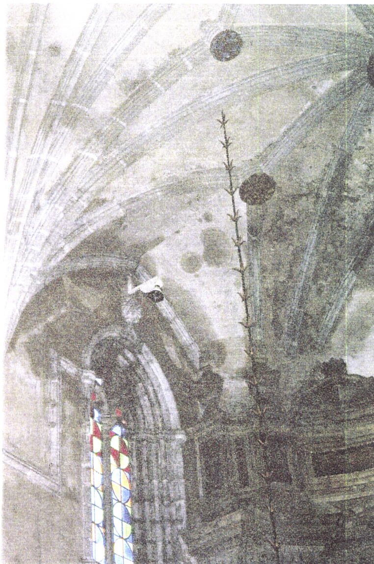
Fig. 9.2 – Igreja de S. Francisco de Évora. Parede lateral Norte da cabeceira: fenda vertical com origem no fecho do arco da fresta, com continuidade na abóbada, e manchas de humidade na mesma zona
