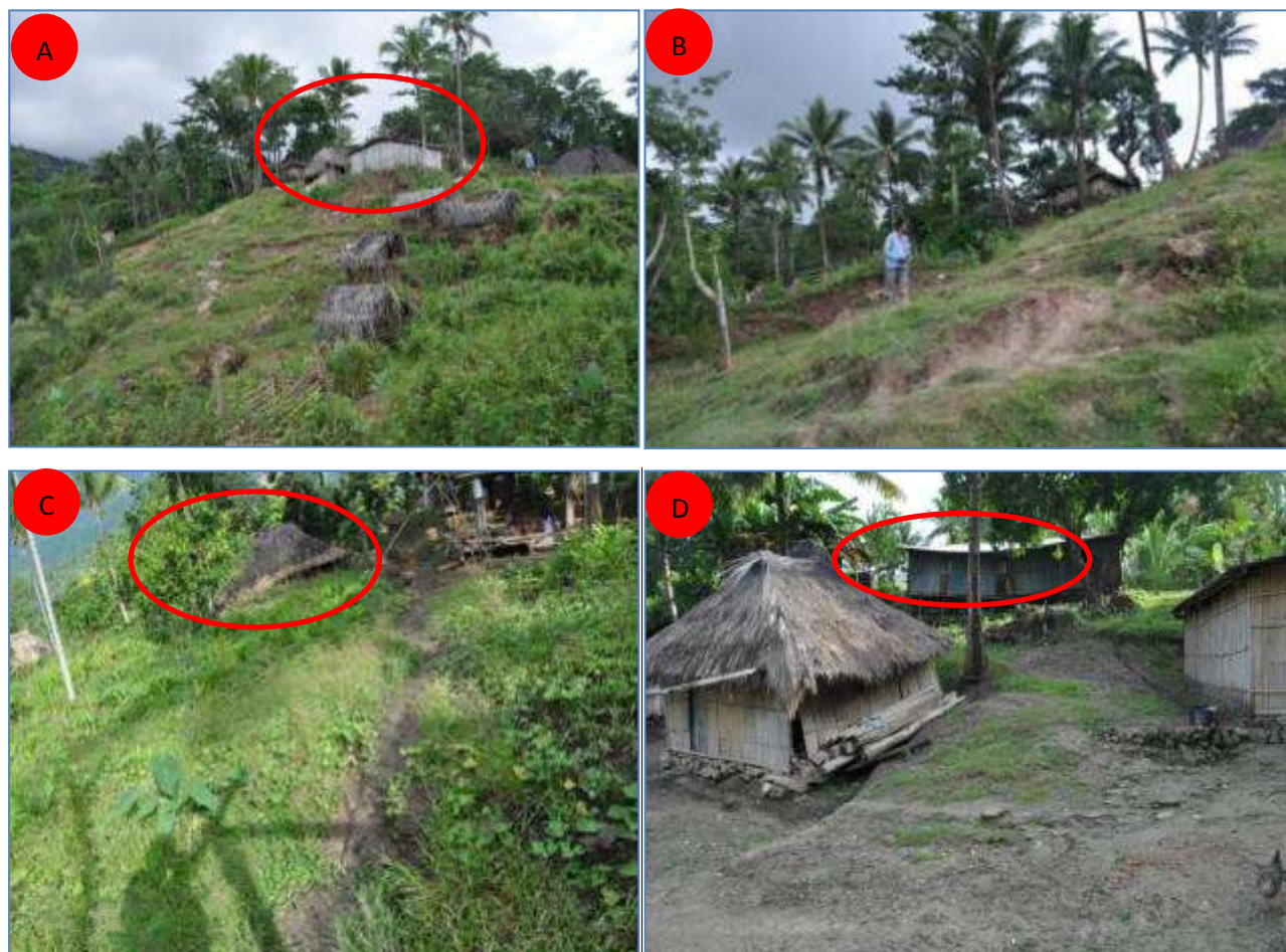
Figura 27. Escorregamentos que afectaram casas em Baguia
