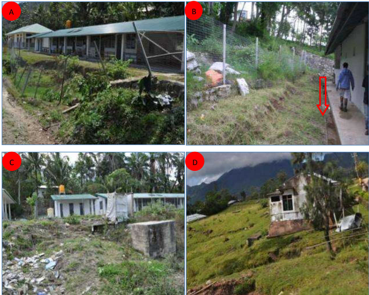
Figura 26. Escorregamentos que afectam os hospitais na zona de trabalho em Baguia
