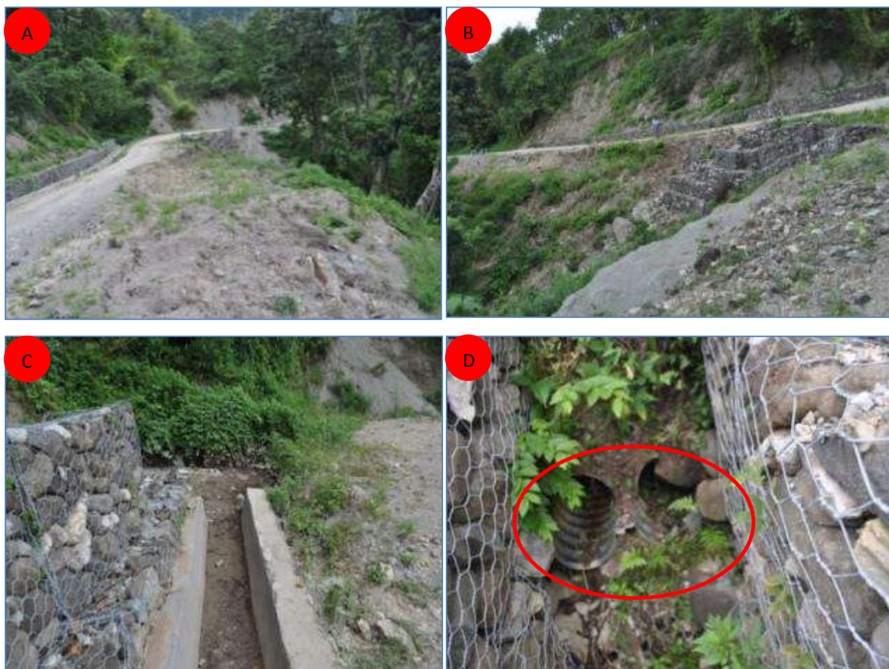
Figura 25. Escorregamentos que afectaram as estradas em Baguia
