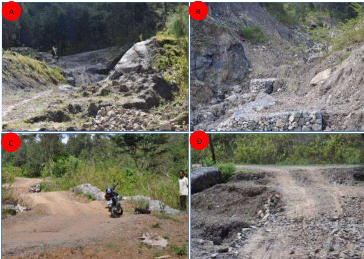
Figura 30. Escorregamentos nas estradas em Quelicai Bualale
