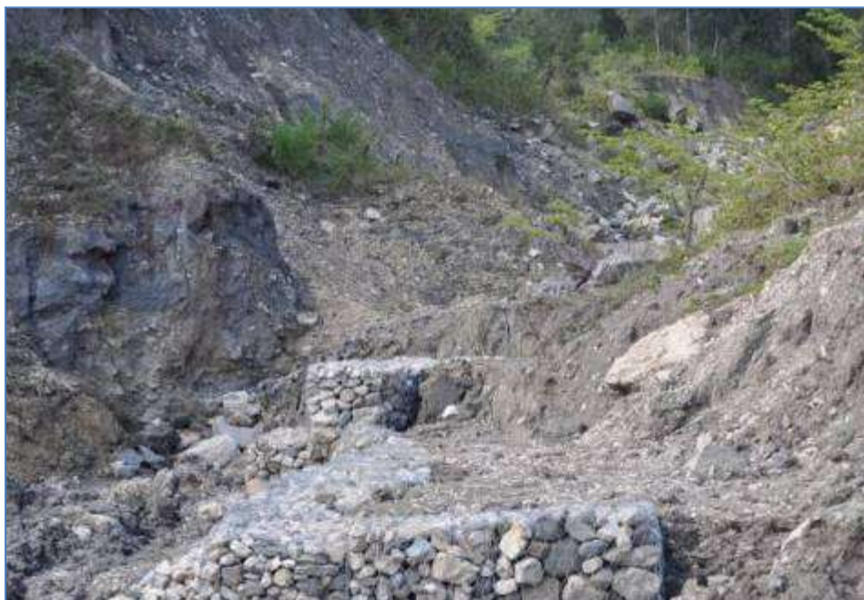
Figura 21. Escorregamento de maior dimensão que ocorreu na área de Bualale
