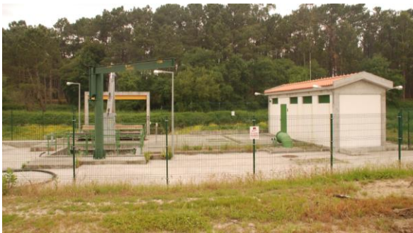
Figura 32 – Estação de bombagem.
