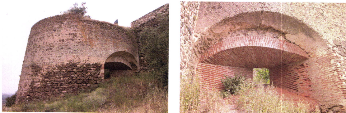
Fig. 4.57 – Torreão da Cerca Medieval de Évora-Monte (Levantamento Arquitectónico de Alberto Martinez - IPPAR)
