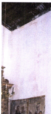
Fig. 4.24 – Infiltrações de água no interior da Igreja Matriz (Foto da autora)
