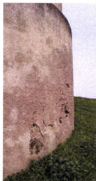
Fig. 4.17 - Arenização do reboco exterior do Paço (Foto da autora)
