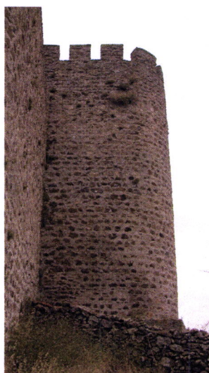
Fig. 4.56 – Perfil de uma das torres medievais que ladeiam a Porta do Freixo da Cerca Medieval de Évora-Monte (Levantamento Arquitectónico de Alberto Martinez – IPPAR)
