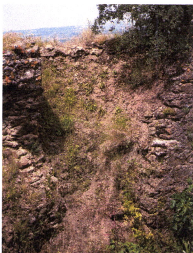
Fig. 4.62 – Derrocada de uma parte da parede interna do Torreão junto à Porta do Sol (Foto da autora)
