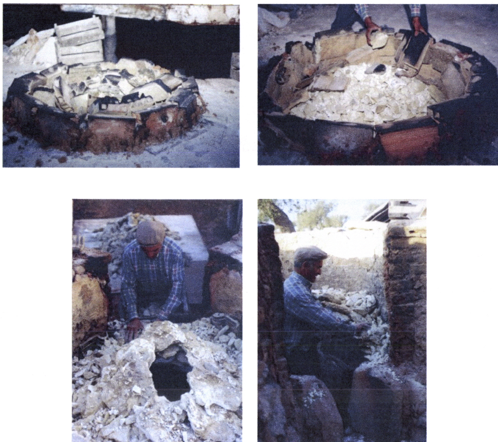
Fig. 4.230, Fig. 4.231, Fig. 4.332 e Fig. 4.333 – idem , desmontagem da cobertura e tiragem da pedra do forno (fotos da autora)
