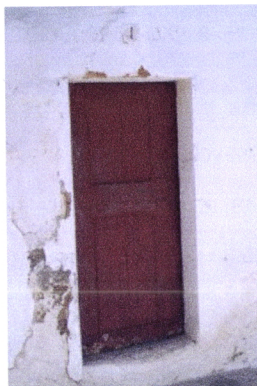
Fig. 4.364 – Moura, Bairro da Mouraria, presença de patologia evidente no paramento – decaimento das camadas de revestimento (foto da autora)
