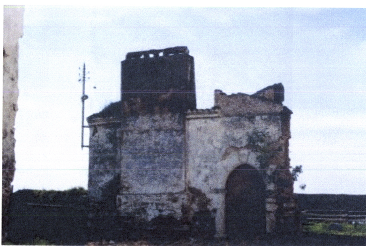
Fig. 4.118 – Castelo de Moura, único edifício habitacional do espaço intra-muros do castelo designada por “casa medieval” (foto da autora)
