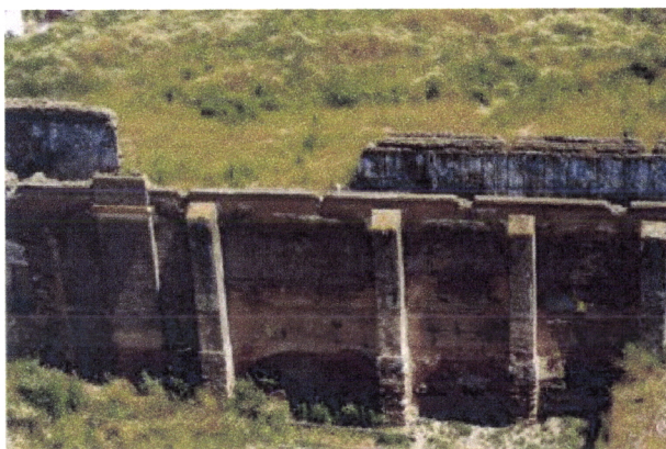
Fig. 4.105 Moura, Convento de Nossa. Sr.ª da Assunção do Castelo, sem cobertura há muito tempo (foto da autora)
