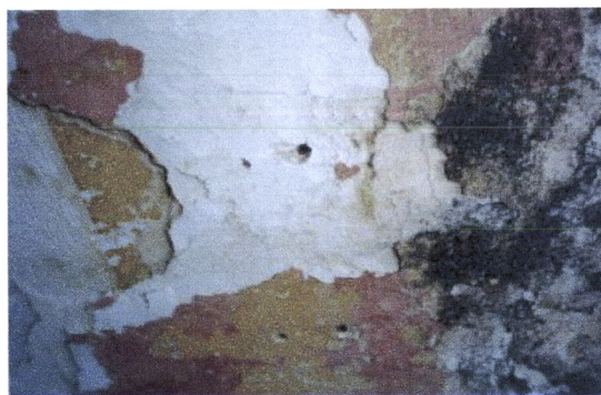
Fig. 4.148 – Moura, Castelo, casa "medieval" do Castelo, definição das camadas sucessivas de pintura e cores aplicadas(foto da autora)
