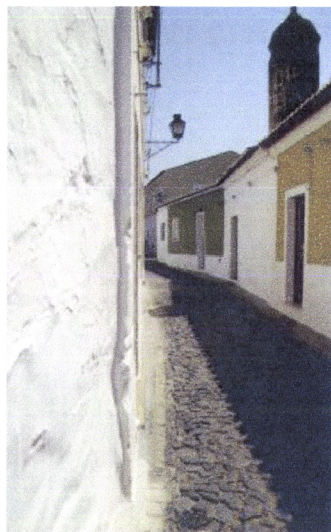
Fig. 2.12 – Moura, Bairro da Mouraria, aplicação de cores não apropriadas nas fachadas de alguns edifícios. (foto de Carolina Fialho)
