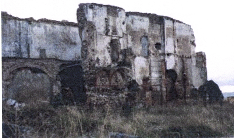
Fig. 3.1- Moura, Convento de Nossa Sr. a da Assunção do Castelo num estado de degradação avançado.(foto da autora)
