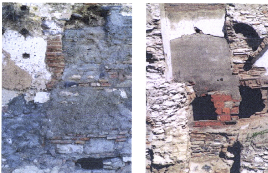
Fig. 3.13 – Moura, Castelo, Convento de N. Sr.ª da Assunção, integração de revestimentos inadequados Fig. 3.14 – Idem , aplicação de materiais inapropriados nos paramentos.
