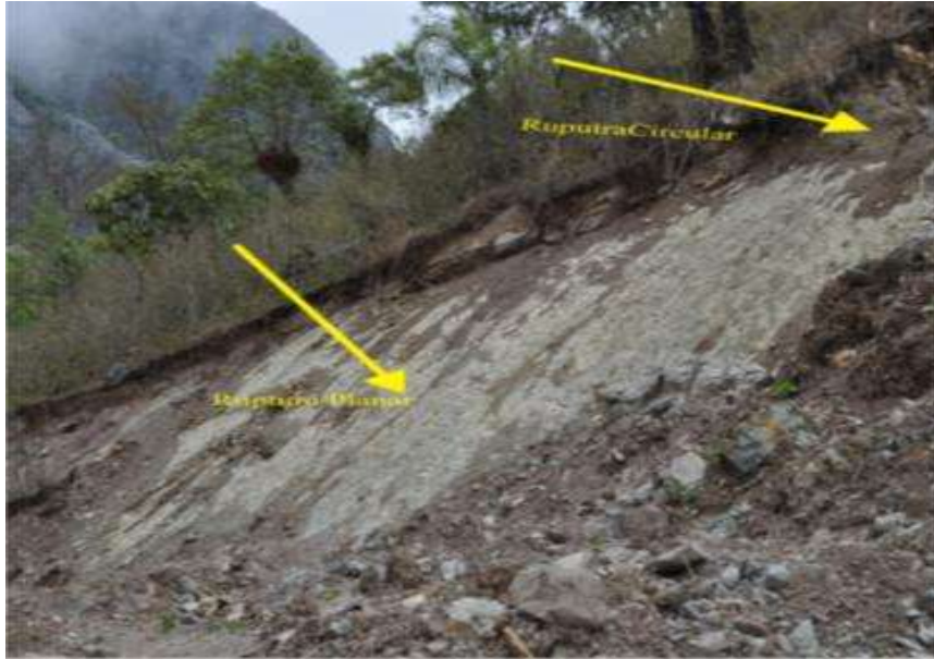
Fig: 3.9 Superfície do escorregamento translacional na estrada para Ossu
