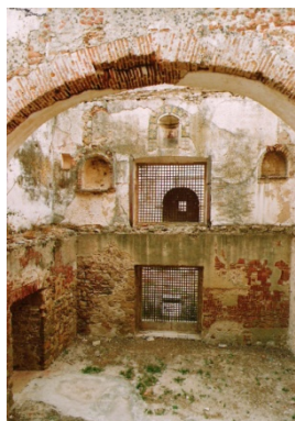
Figura 157 ■ Igreja em ruína.
