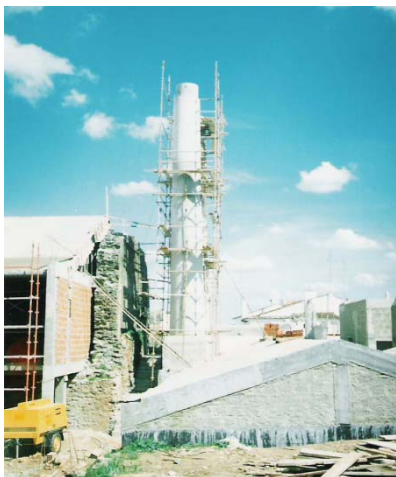
Figura 125 ■ Ala nova. Parede em ruína e chaminés.
