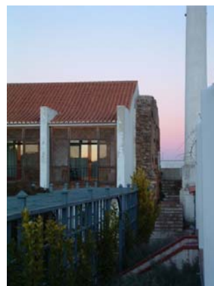
Figura 132 ■ Zona nova. Unidades de alojamento / parede em ruína.
