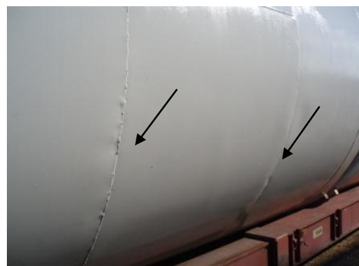
Figura 5.13 Soldaduras dos vários painéis com irregularidades
