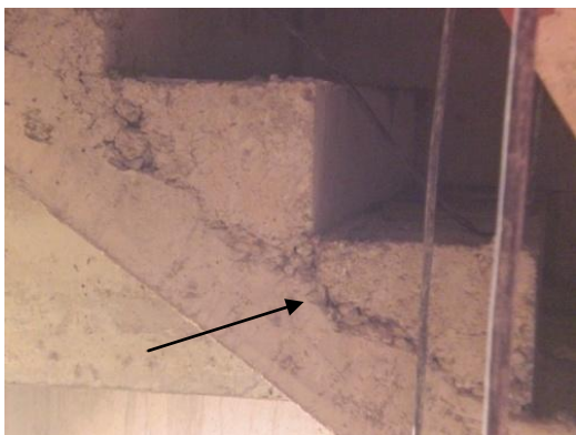
Figura 5.4 Segregação do betão em escadas
