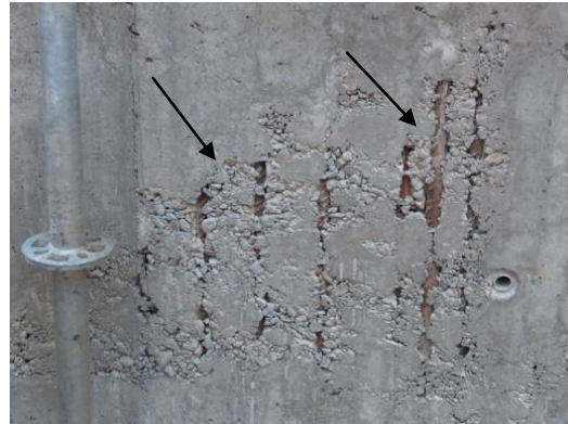
Figura 5.3 Armadura à vista por falta de vibração do betão e recobrimento insuficiente/segregação do betão (em obra designado por betão desagregado)
