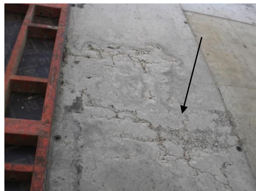
Figura 5.5 Segregação do betão em elementos verticais
