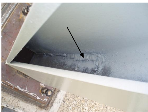
Figura 5.12 Rebarbas de soldadura de uma estrutura metálica
