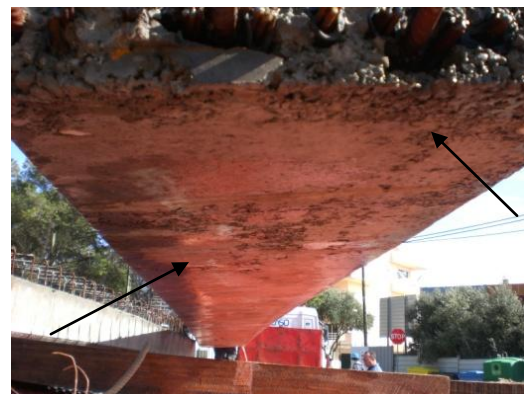
Figura 5.11 Segregação do betão na viga pré-fabricada
