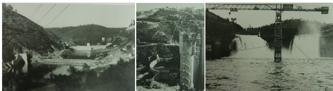
Figura 13 – Imagens da construção da barragem da Aguieira (cortesia da Junta de Freguesia de São Pedro de Alva)
