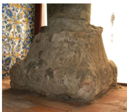
Fig. 32 Coluna de mármore de Alvito com capitel e encimado por um Cruzeiro de calcário com a representação do “Calvário” do Santo pintado a fresco em tons vermelhos (Capela de São Manços, Évora).
