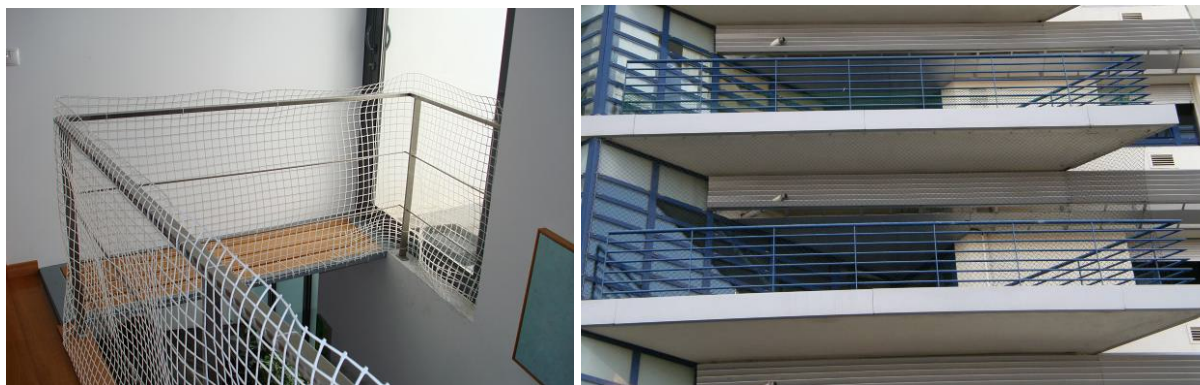
Figura 4 a, b – Soluções de protecção de guardas colocadas à posteriori (Açores, Lisboa).
