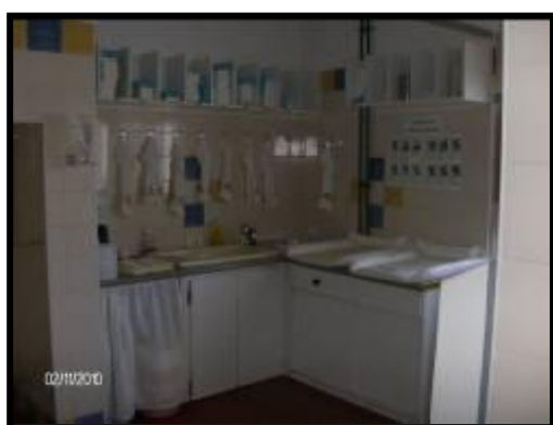
Fig. 6 – Banheira e muda fraldas da casa de banho de Creche
