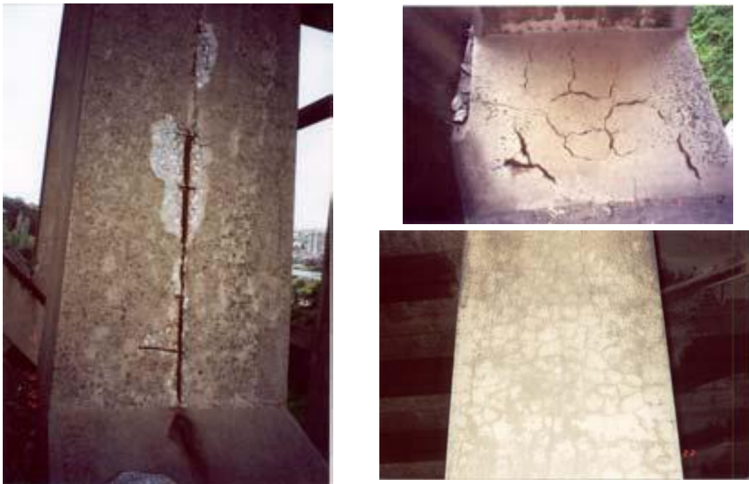
Figura 96: Patologias registradas no V. D. P. típica das reações expansivas da origem interna e a corrosão de armaduras [58] .
