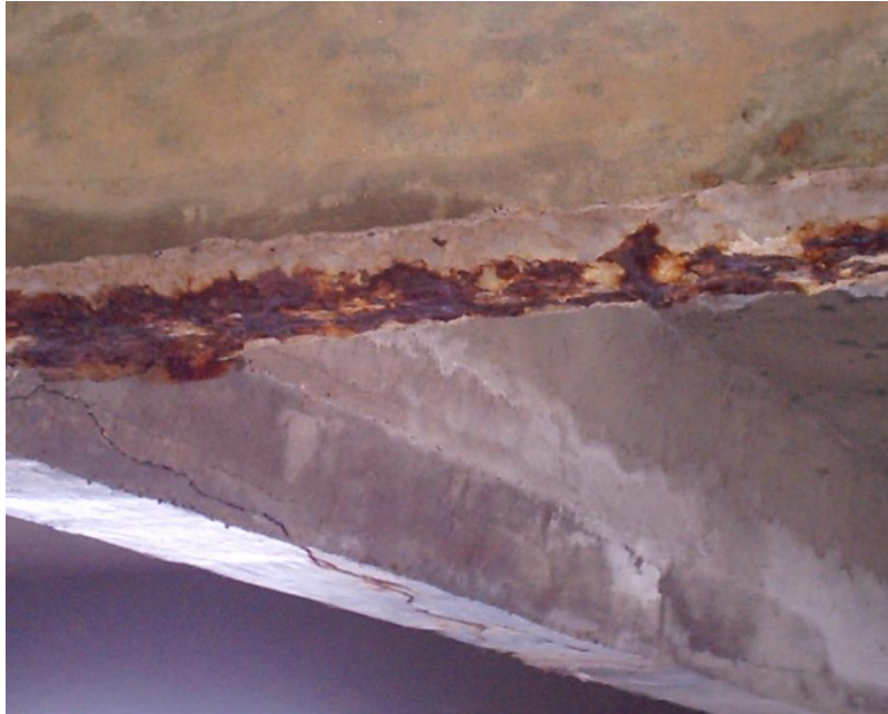
Figura 17: Expansão por ataques por sulfatos e por corrosão em zona próxima ao mar [12] .
