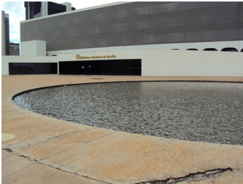
Figura 13: Fissuração tipo map-cracking no espelho d'água da Biblioteca Nacional de Brasília, Brasil.
