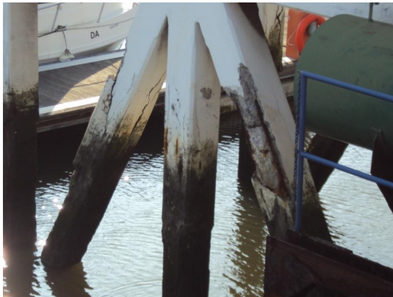
Figura 21: Despassivação das armaduras por ingresso de iões cloreto, Doca do Bom Sucesso, Lisboa, Portugal.
