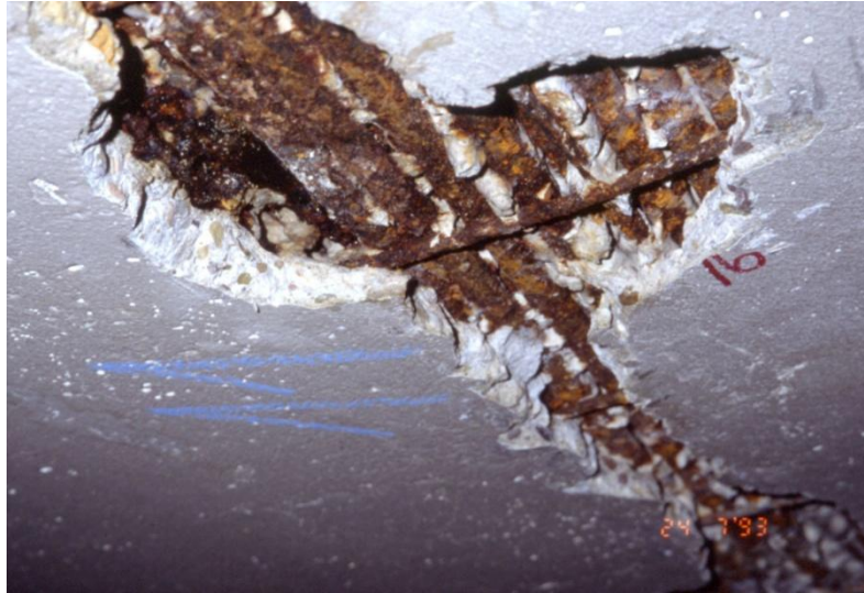
Figura 56: Danos causados pela carbonatação em uma estrutura de betão armado [37].
