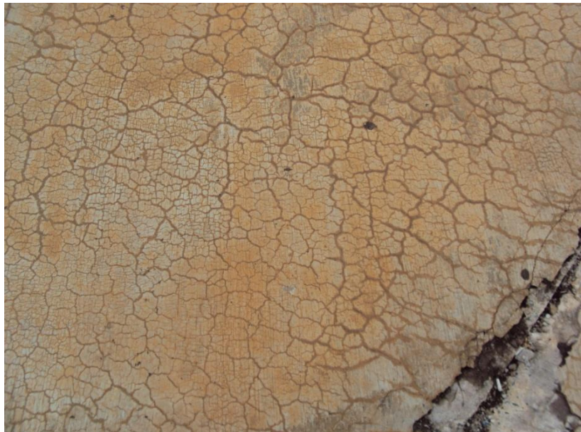
Figura 71: Pormenor dos efeitos da reação álcalis-agregado no betão fissuras em rede e destacamento, Biblioteca Nacional de Brasília, Brasil.
