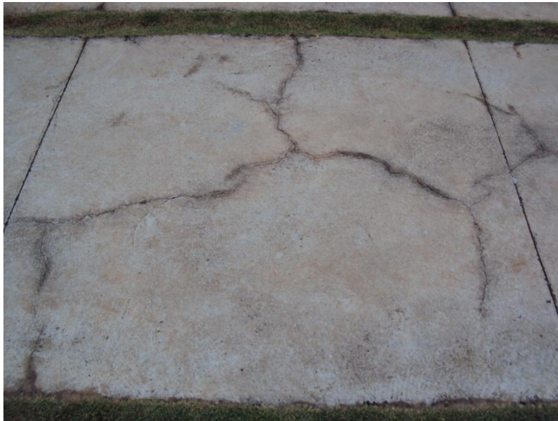
Figura 42: Pormenor dos danos na calçada de betão em contato direto com o solo, Palácio da Alvorada, Brasília, Brasil.
