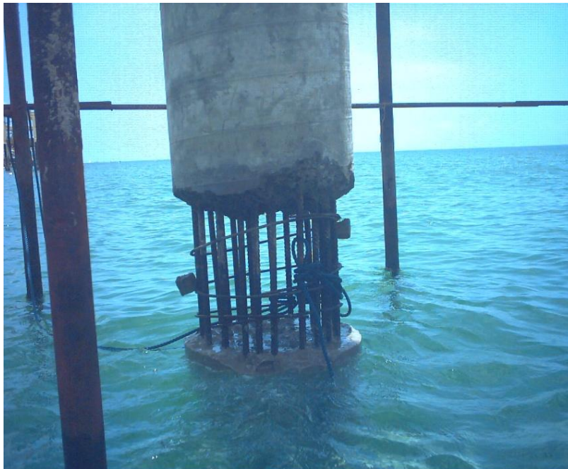
Figura 30: Patologia grave provocada pela ação da água do mar, onde todo o betão afetado pela ação da maré foi “eliminada” [19] .
