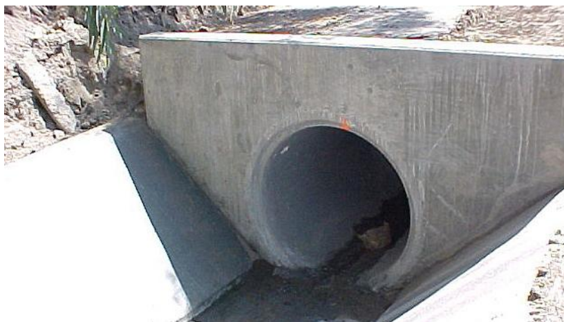
Figura 35: As estruturas de betão destinadas aos esgotos são as mais vulneráveis aos ataques por ácidos (23) .
