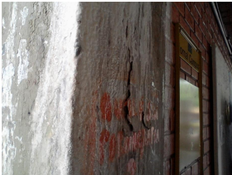
Figura 15: Percolação de água e ocorrência de depósitos e incrustações calcárias na UnB, Brasília, Brasil.
