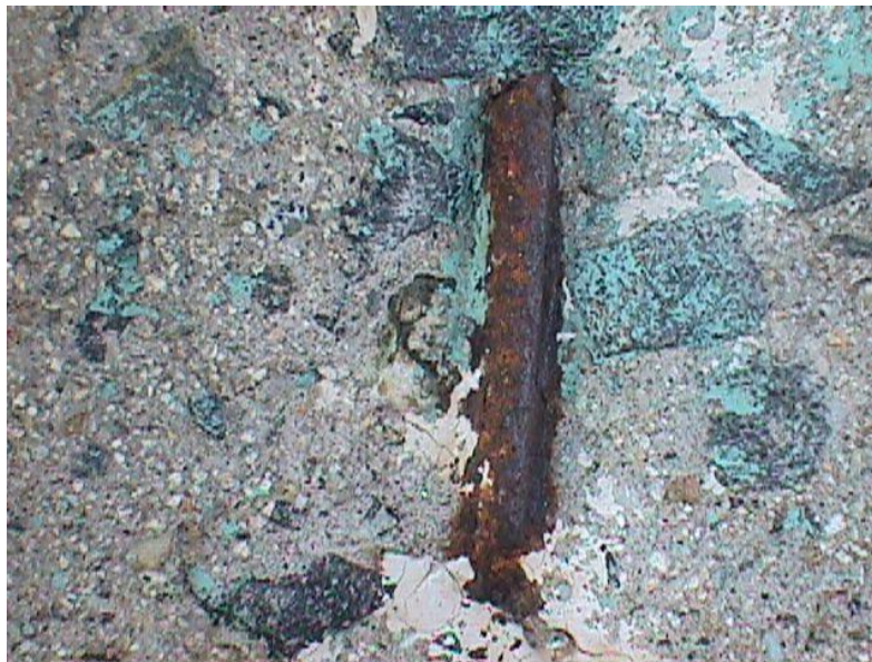
Figura 40: Ataque por sulfatos com consequente corrosão da armadura [28] .
