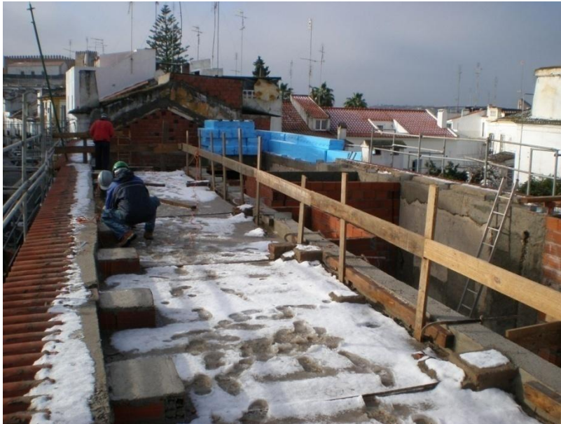
Figura 14: Ação da variação térmica em Évora, Portugal (ciclo gelo/degelo), pode desencadear o surgimento de fendas no betão [10] .
