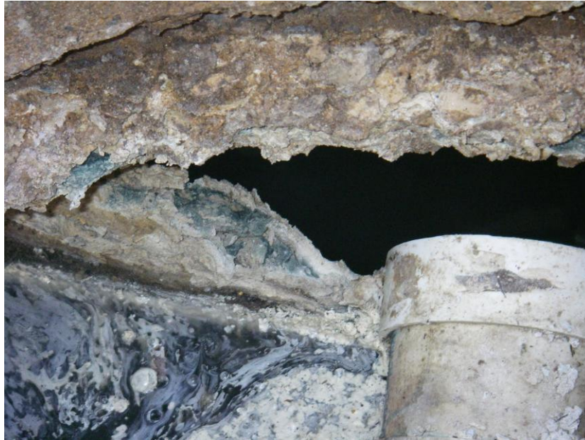
Figura 38: Graves danos em um coletor de esgotos provocada por ataques ácidos no betão [26].
