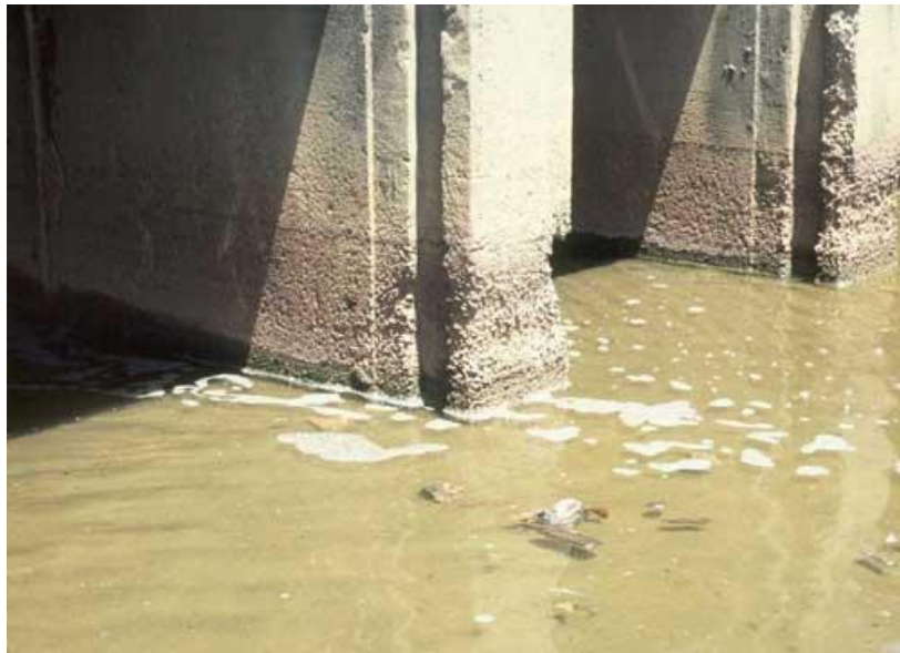
Figura 31: Patologia provocada pela ação da maré em uma estrutura de betão (20).
