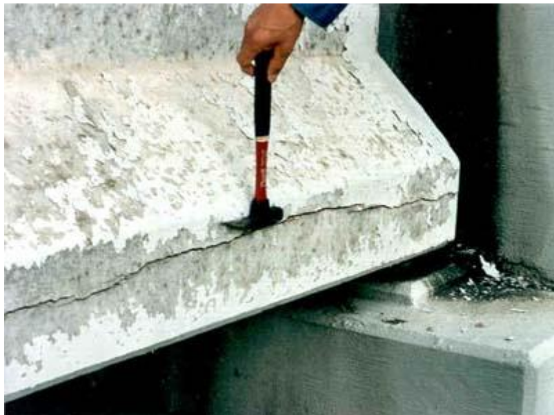
Figura 79: Fenda no betão provocada pela RAS [50].
