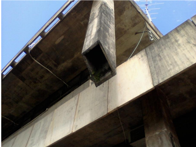
Figura 49: Incrustações de plantas em calha de escoamento de águas pluviais em betão, Reitoria da UnB, Brasil.
