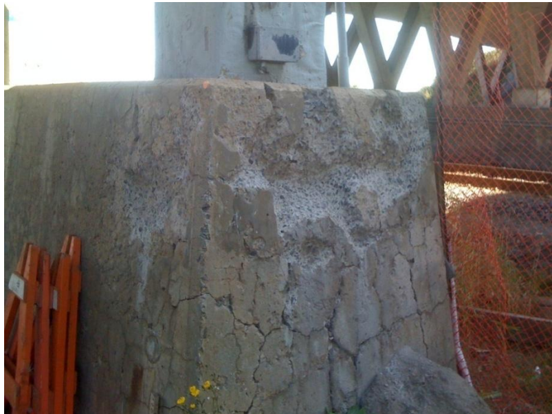
Figura 16: Ataques por lixiviação na base de um pilar de um viaduto que esteve em contato com a água (11).
