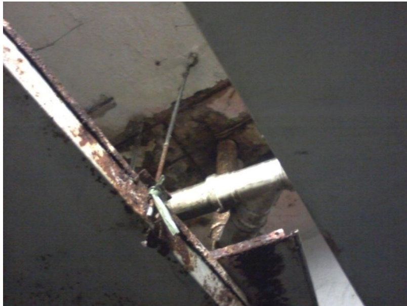
Figura 50: Danos provocados por um vazamento de um tubo de esgoto num supermercado, Brasília, Brasil.
