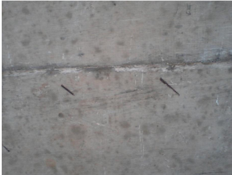
Figura 3: Recobrimento insuficiente em uma laje de betão da Universidade de Brasília, Brasil.
