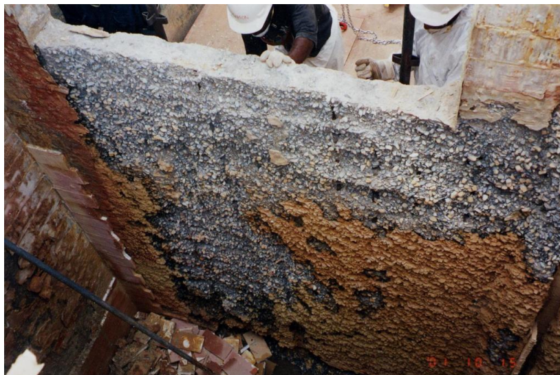
Figura 36: Reparação de um reservatório de tratamento de águas residuais sujeito a ataque ácido (24) .
