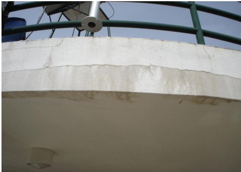
Figura 11: Patologia relacionada com ataque químico no edifício da Universidade de Évora, Portugal.
