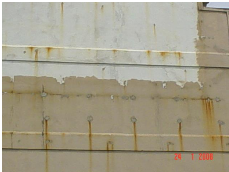
Figura 91: Foto de patologias provocadas pela instalação de um painel publicitário [56].
