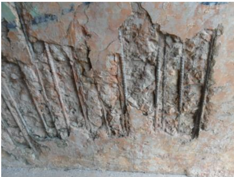
Figura 20: Despassivação das armaduras por carbonatação, viaduto Flamboyant, Goiânia, Brasil [14].
