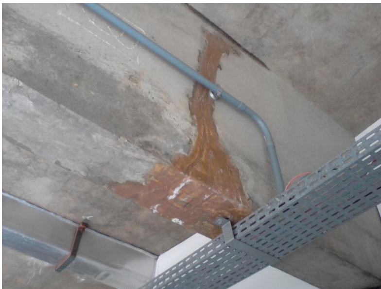
Figura 26: Tentativa fracassada de reparação da percolação de água, ainda se verifica a ocorrência de depósitos e incrustações calcárias, UnB, Brasília, Brasil.
