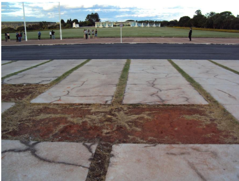
Figura 41: Danos na calçada de betão em contato direto com o solo, Palácio da Alvorada, Brasília, Brasil.
