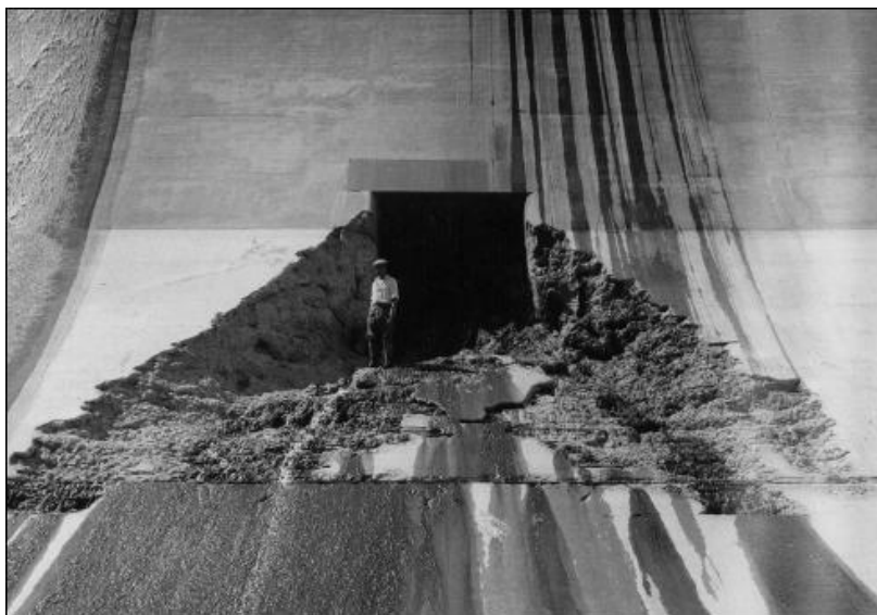
Figura 23: Efeitos da cavitação, Miranda, 1966 [15] .
