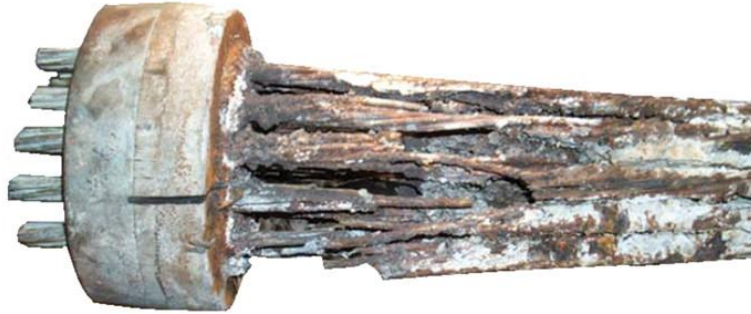
Figura 61: Corrosão nos cabos de pré-esforço de uma estrutura de betão pré-esforçado [22].
