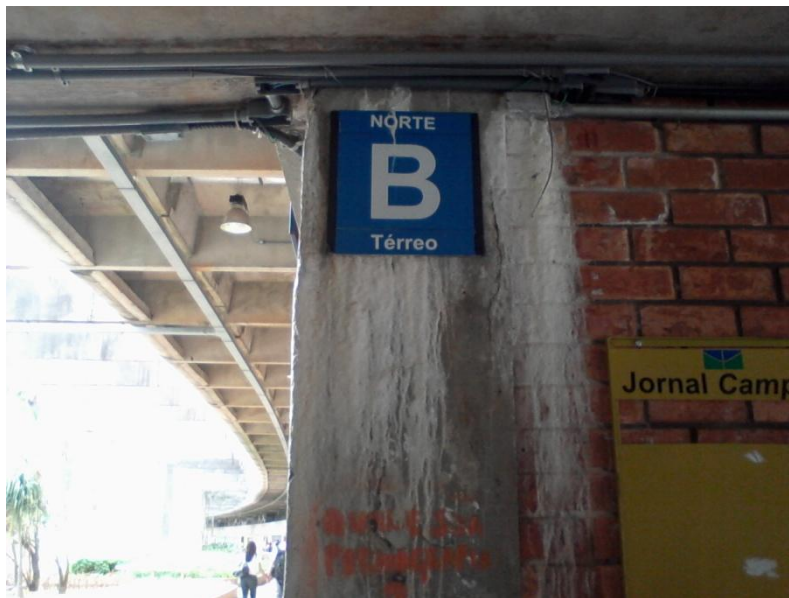
Figura 25: Percolação de água e grande ocorrência de depósitos e incrustações calcárias, UnB, Brasília, Brasil.
