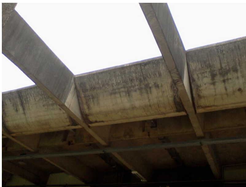
Figura 29: Manchas provocadas pela ação das águas da chuva, Universidade de Brasília, Brasil.
